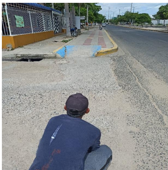
Fisura transversal entre PS6 y PS7
