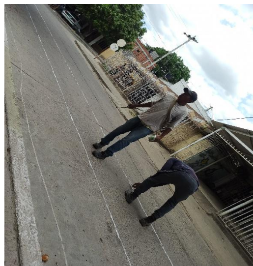
Fisuras longitudinales en la calle 16b
