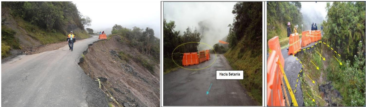
Figura 01. Afectaciones Viales por remoción en masa
