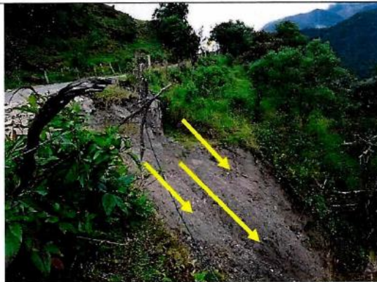
Fotografía 4. Flujo del suelo en el costado oriental de la vía.
