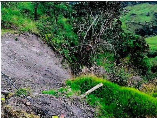
Fotografía 5. Desplazamiento, desprendimiento y pérdida de verticalidad de los individuos arbóreos.
