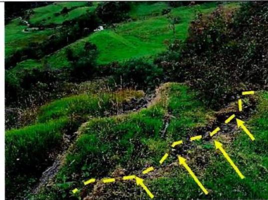
Fotografía 6. Parte alta de la ladera donde se presentan grietas de tracción con abertura aproximadas de 15 cm.
