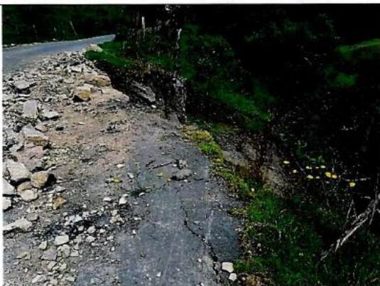
Fotografía 3. Desconfinamiento de la banca de la vía que conduce a Nazareth sentido Sur-Norte.
