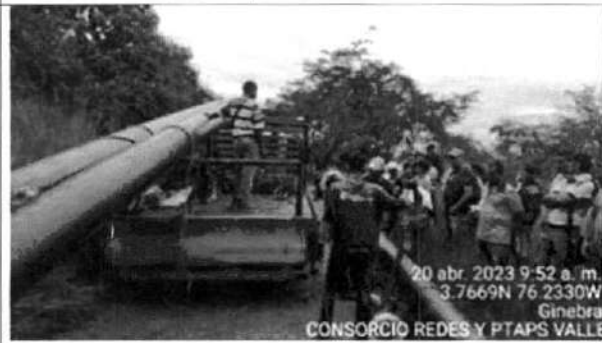
Fotografía 32. Las actividades de instalación de tubería en el tramo 3 se suspenden por manifestaciones en contra del proyecto.
