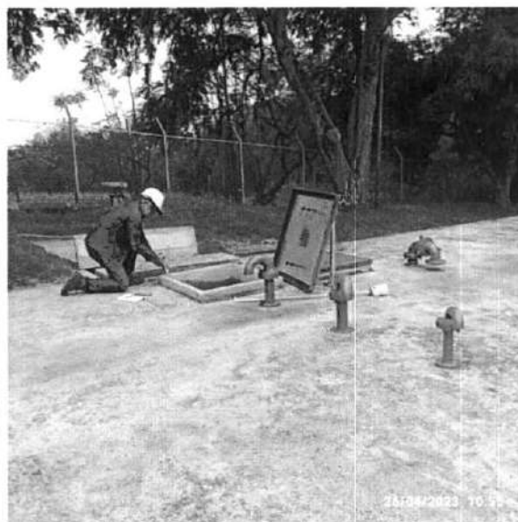
Fotografía 56. Chequeo niveles del tanque almacenamiento
