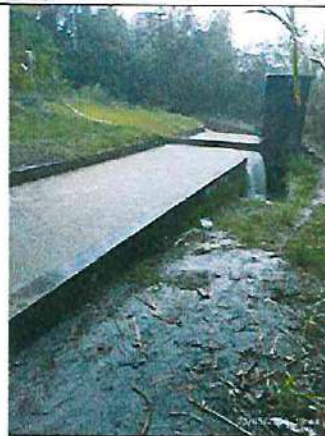
Fotografía 52. Desarenador del sistema que conduce el agua de bocatoma de Puente Rojo a PTAP Ginebra
