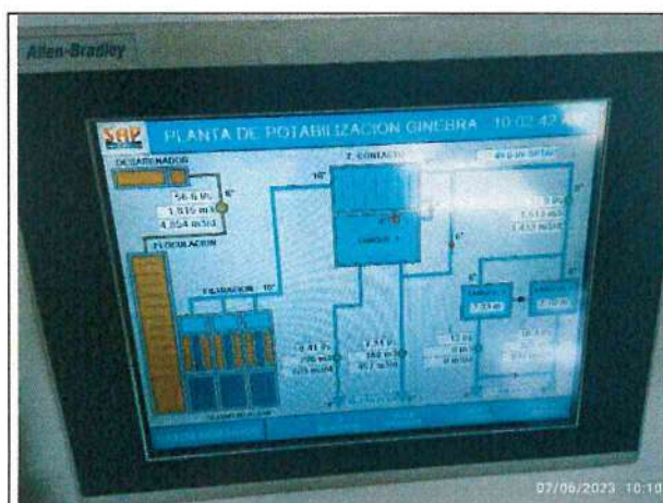
Fotografía 49. Tablero de control PTAP y Tanques Ginebra
