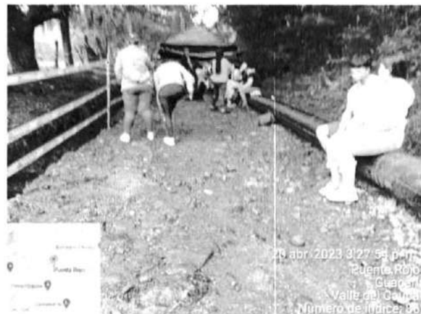
Foto N° 6: Abscisa K0+400 tubería unida que fue retirada de la zanja, por la comunidad ubicada en el eje izquierdo de la vía
