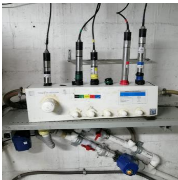
c) Montaje actual Estación Aula Ambiental
