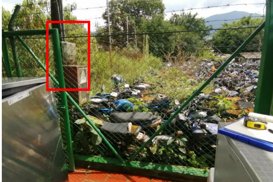
Foto 4. Ubicación actual contador eléctrico estación Ancón Sur
