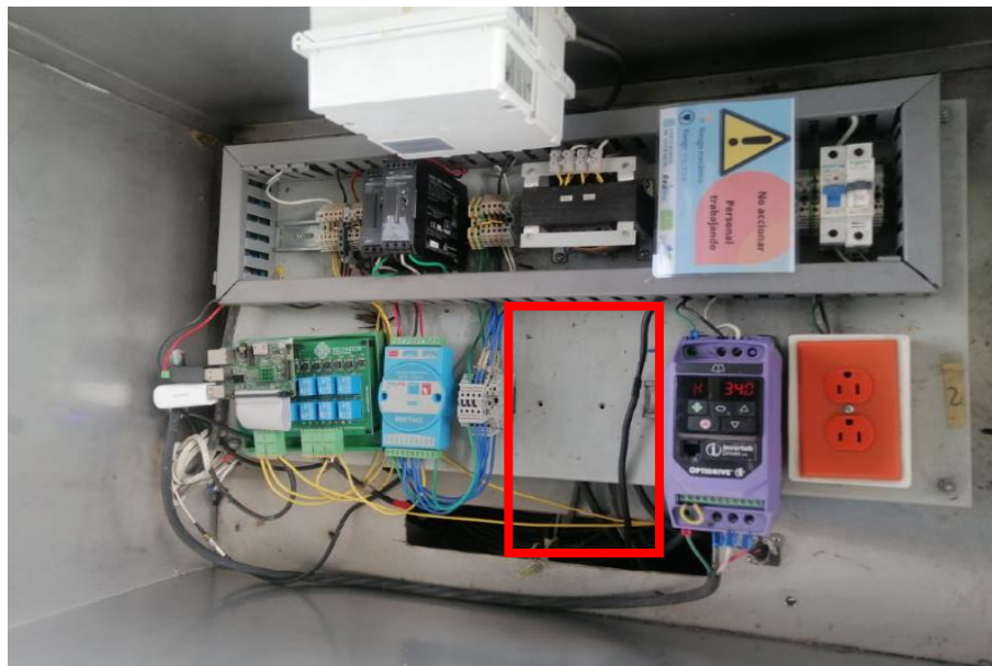
Foto 3. Compartimiento eléctrico estación Ancón Sur
