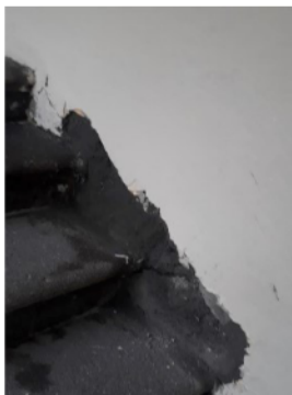
Humedades por capilaridad
