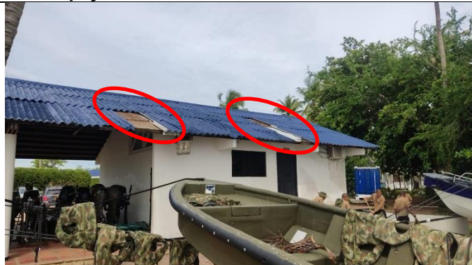
Kiosco botes CIEAN. Desprendimiento de teja en la cubierta del Kiosco de entrenamiento del CIEAN.
