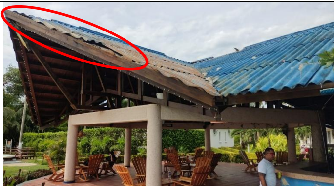
Kiosco "Popeye". Desprendimiento de tejado en cubierta de Kiosco "Popeye"
