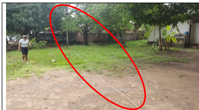
Casa 4. Detrás de la casa 4 línea de baja tensión caída con inminente riesgo para el personal abordó y sus familias.
