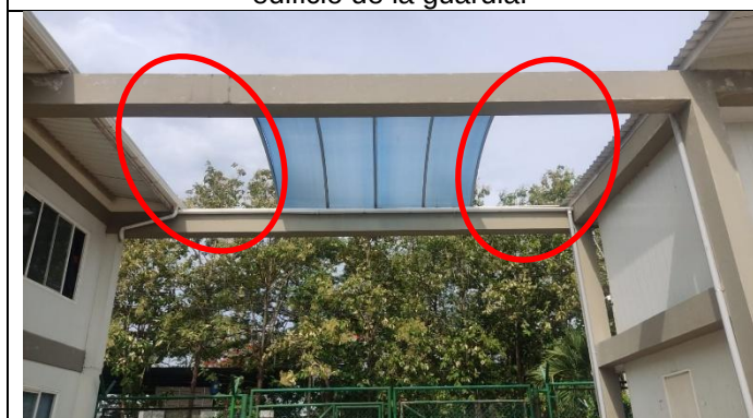
EGCOV. Desprendimiento de teja de ingreso a la guardia de la estación de guardacostas.
