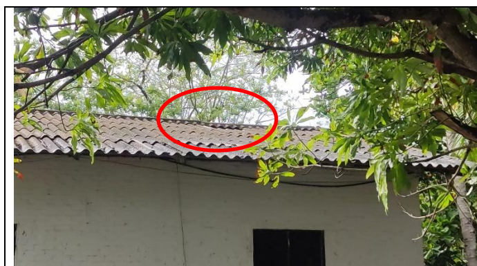
Casa 2. Teja corrida por fracturación de amarres.
