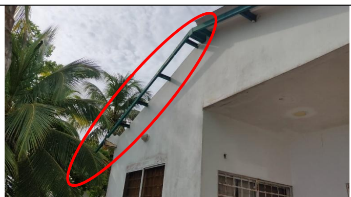
Casa 1. Desprendimiento de teja en casa migración Colombia.
