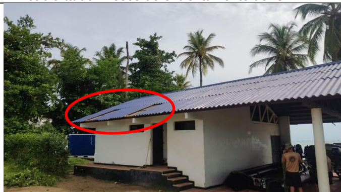
Kiosco botes CIEAN. Desprendimiento de teja en la cubierta del Kiosco de entrenamiento del CIEAN.
