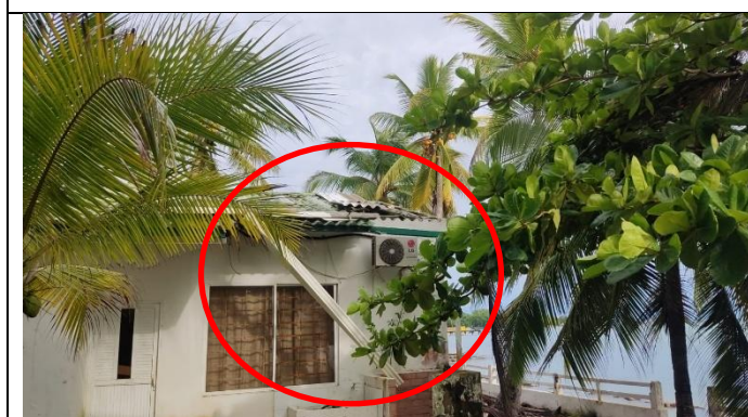
Casa 1. Desprendimiento tejado casa migración Colombia y caída de viga canal.
