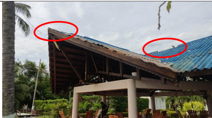
Kiosco "Popeye". Desprendimiento de caballete en cubierta de Kiosco "Popeye".
