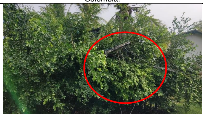
Casa 1. Derrumbe de poste con líneas de baja tensión causado por la caída de un árbol en la parte de atrás de la casa migración Colombia
