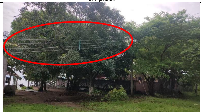
Casa 3. Líneas de baja tensión de red abierta caídas detrás de casa 3 y casas a la orilla del mar.
