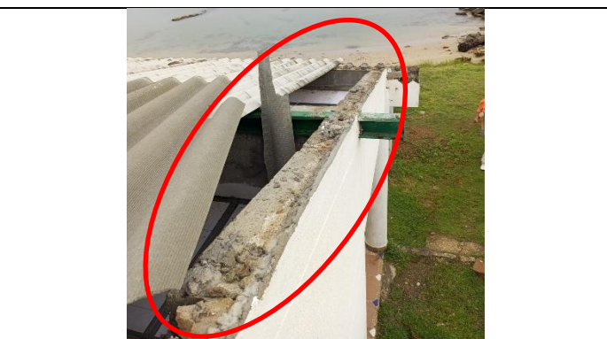
Casa 80. Desprendimiento de cubierta de la casa 80 vista superior
