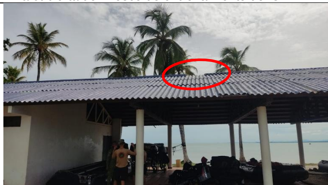
Kiosco botes CIEAN. Desprendimiento de caballete en la cubierta del Kiosco de entrenamiento del CIEAN.
