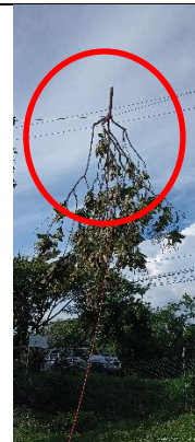
Daño en linea interna de red de media tension por caída de arbol sobre la liena
