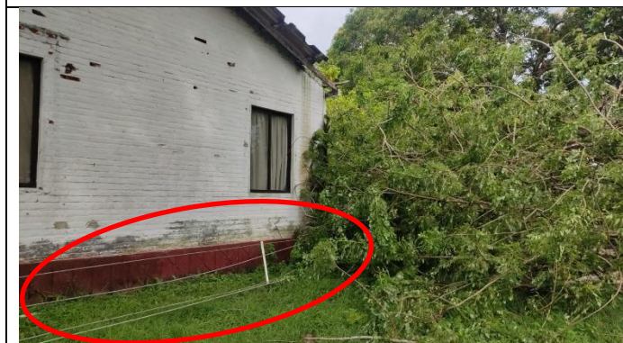
Casa 7. Caída de árbol y derrumbe de poste con líneas de baja tensión.
