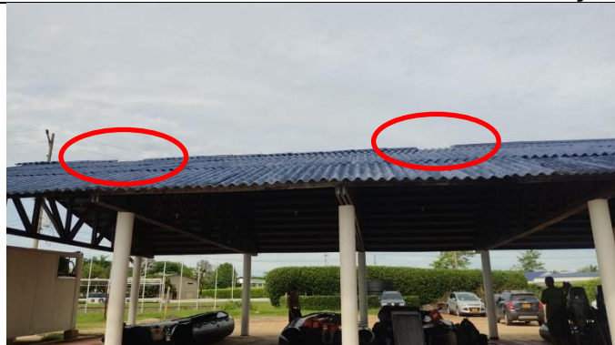
Kiosco botes CIEAN. Desprendimiento de caballete en la cubierta del Kiosco de entrenamiento del CIEAN.
