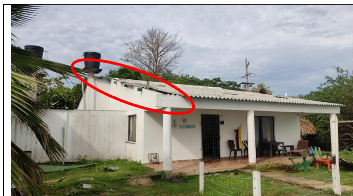
Casa 80. Desprendimiento de cubierta de la casa 80 vista frontal
