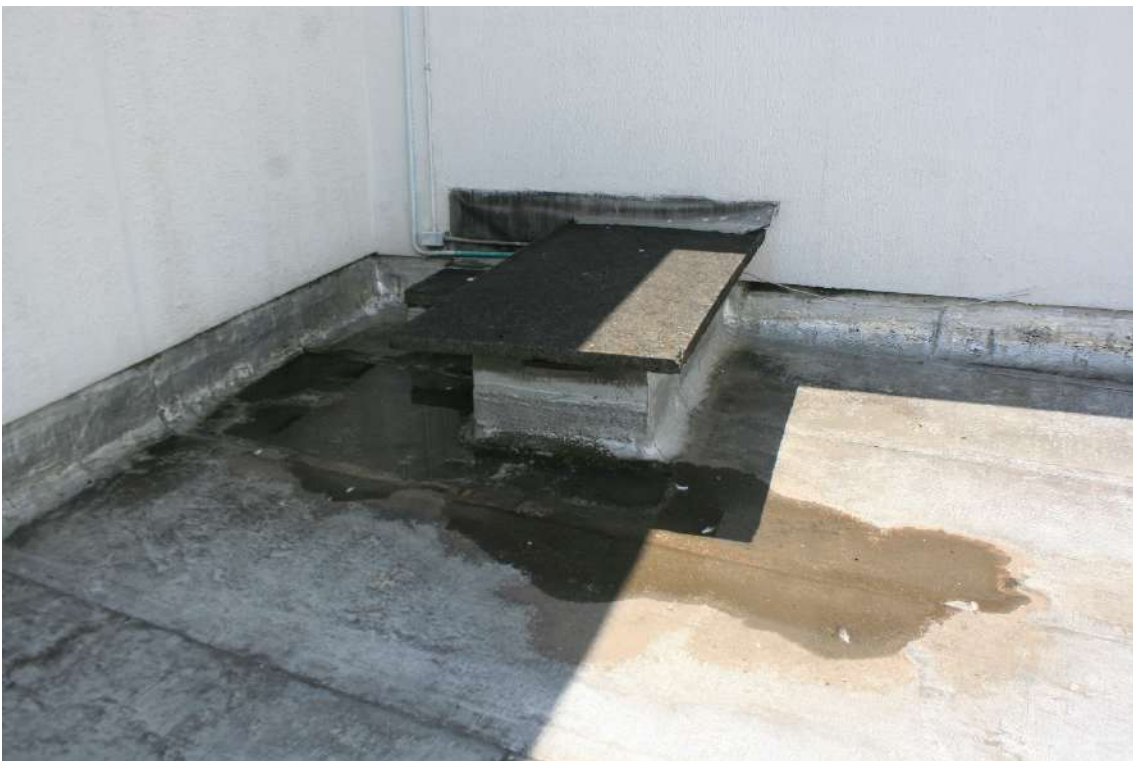
Empozamiento de aguas terraza torrea para reparación con mortero
