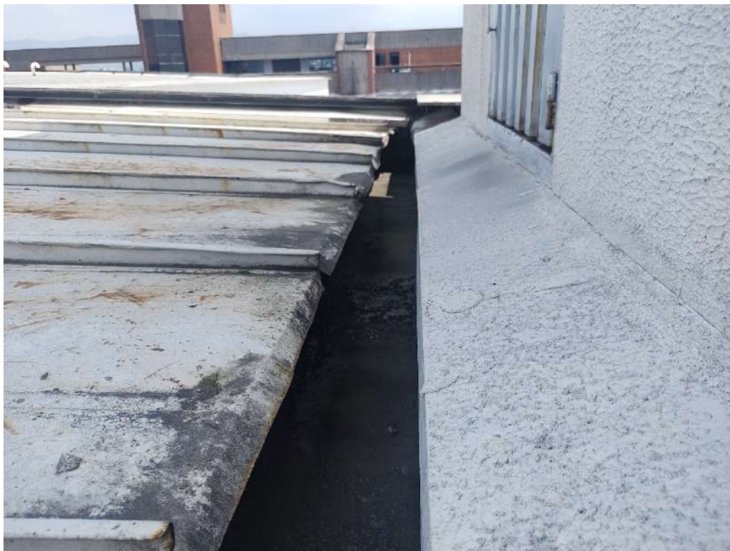
Estado actual canales cubierta gimnasio
