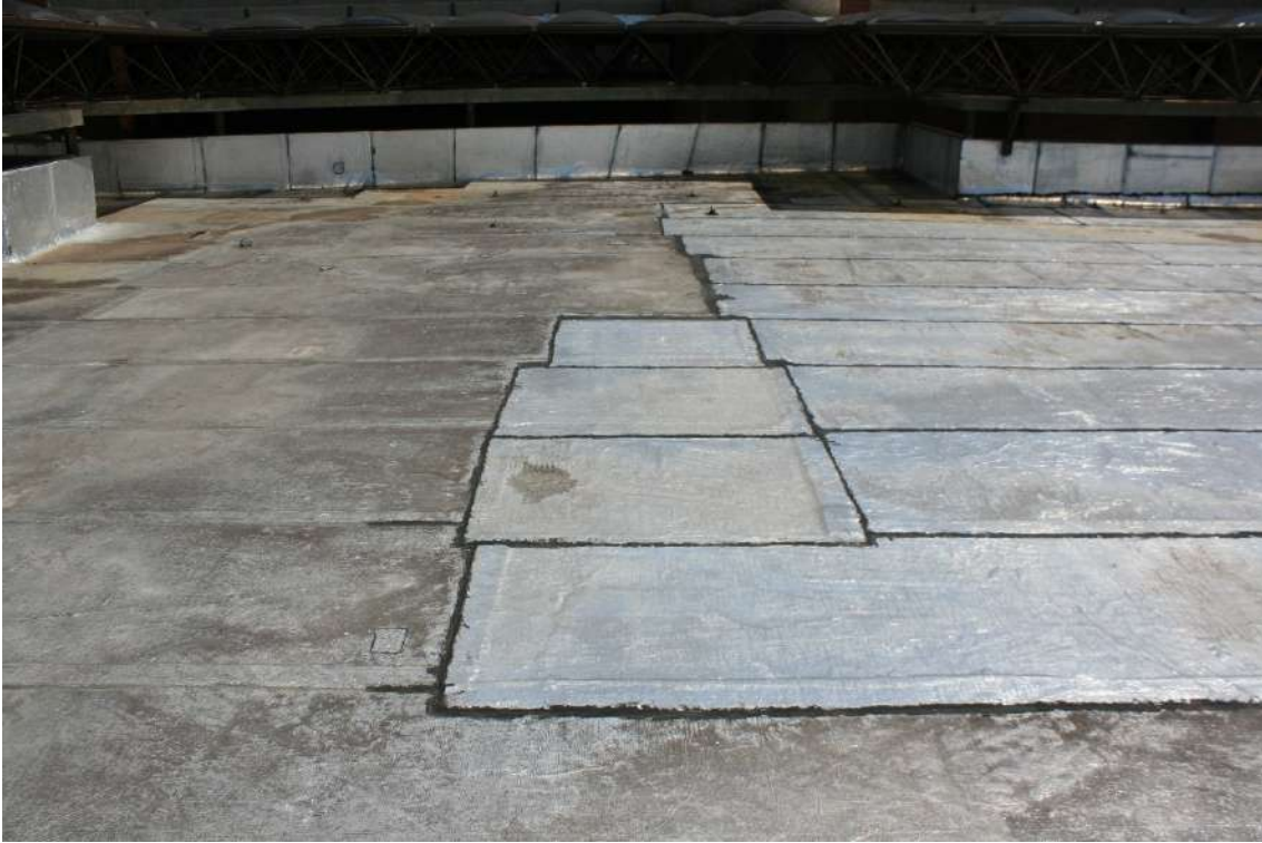
Vista general estado actual de la terraza de la Torre A empalme entre mantos
