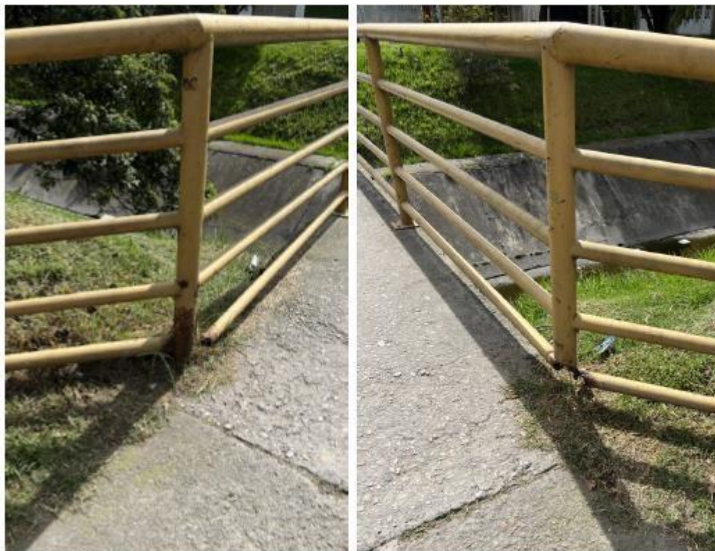
Pérdida de sección parcial y total en los postes de las esquinas debido a la orina de perro.
