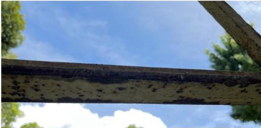
La celosía muestra un deterioro avanzado por corrosión.
