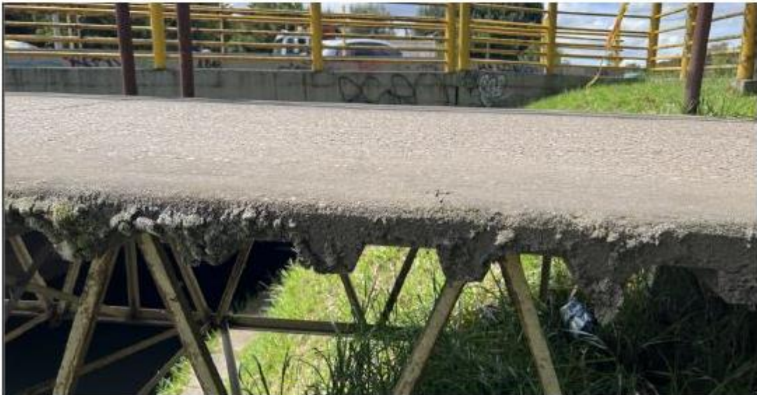
La superficie del tablero muestra exposición del agregado.
