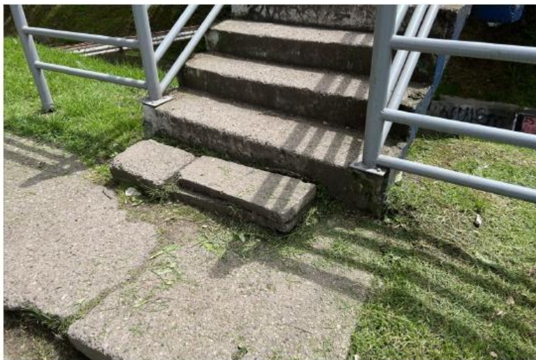
Pasos de escalera incompletos, anclajes de la baranda en aparente buen estado y perdida de sección de postes de barandas.
