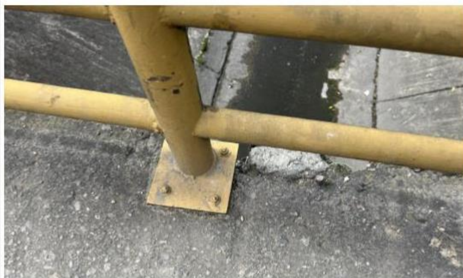
Desprendimiento del concreto en zonas de anclajes de barandas.
