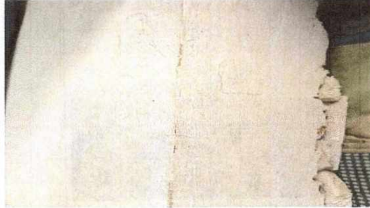
Foto No 4 Descripción se evidencia desprendimiento de material
