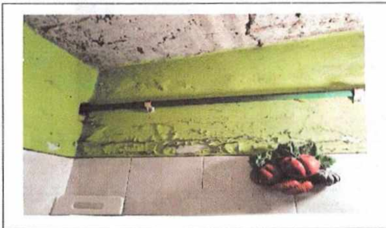
Foto No 8 Descripción Se evidencia desprendimiento de material en muro
