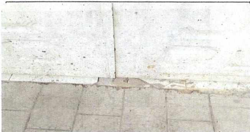
Foto No 5 Descripción Se evidencia desgaste de material en puerta
