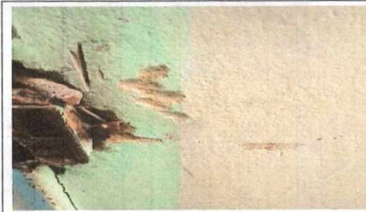
Foto No 8 Descripción Se evidencia desprendimiento de materia y fisura de 3ml. de ancho
