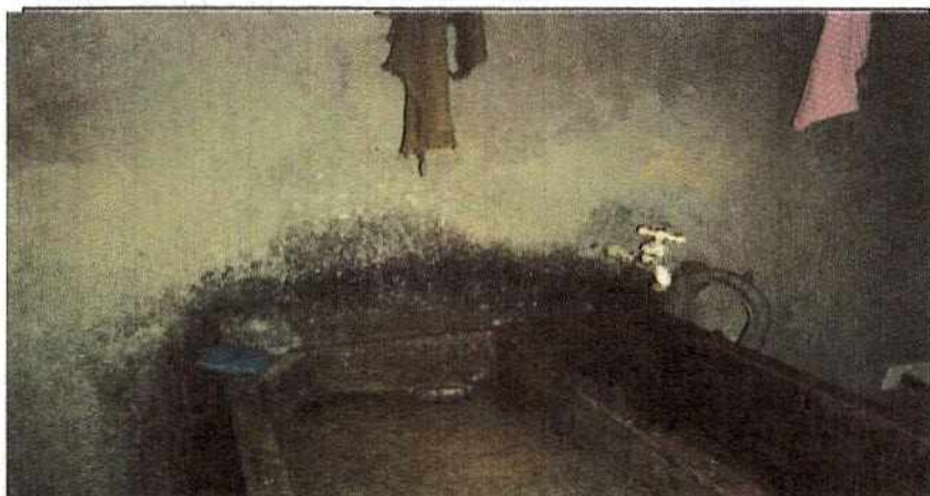
Foto No 7 Descripción presencia de humedad en zona de pared
