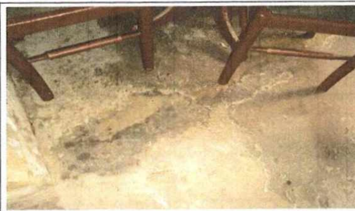
Foto No. 6 Descripción Piso con retracción en el cemento.
