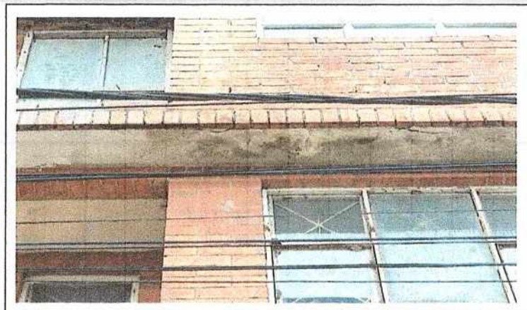
Foto No 5 Descripción Carpintería metálica con oxidación.
