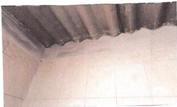
Foto No 5 Descripción Falta relleno muro contra los techos externos
