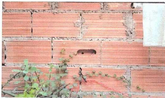
Foto No 3 Descripción se evidencia desprendimiento de material en Bloque.
