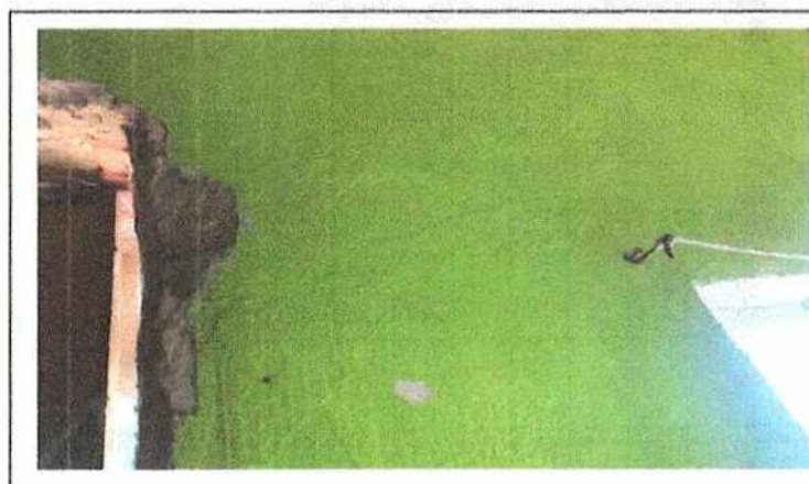
Foto No 3 Descripción remate en marco de puerta con cemento y rugosidad en pañete de muro
