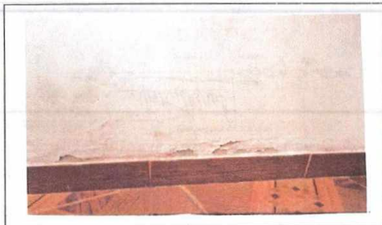
Foto No 5 Descripción Se evidencia desprendimiento de material
