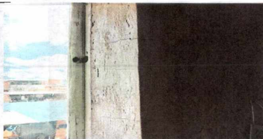
Foto No 2 Descripción Se evidencia fisuras en fido.
