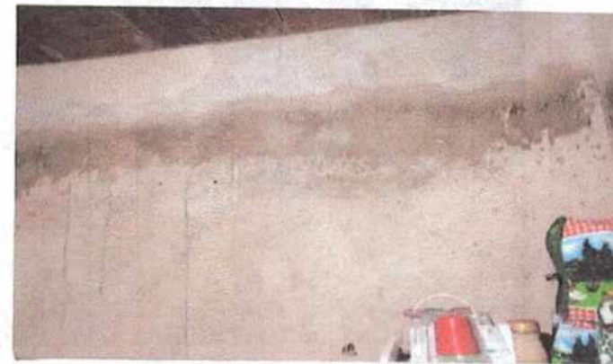
Foto No 6 Descripción se evidencia humedad sobre muro
