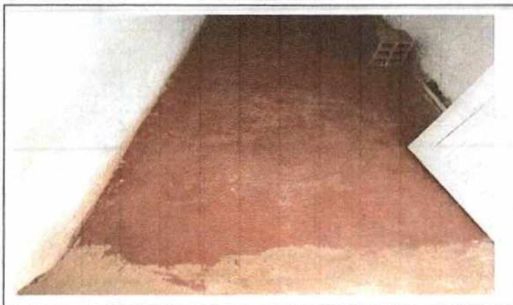
Foto No. 5 Descripción Se evidencia desgaste en Pared.
