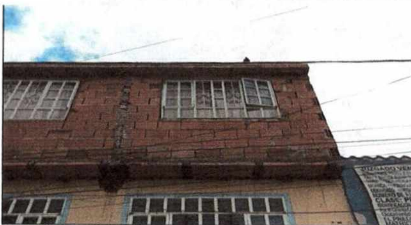
Foto No 3 Descripción Se evidencia desprendimiento de material
