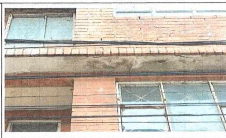
Foto No 2 Descripción: Placa de entre piso con humedad
