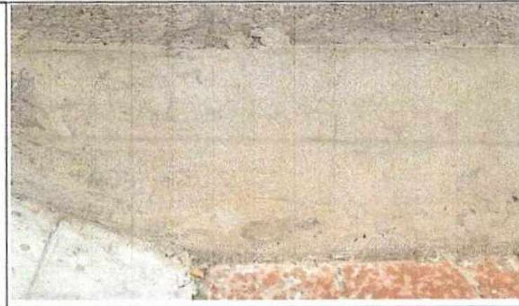
Foto No 6 Descripción Placa antepecho con retracción en el pariete
