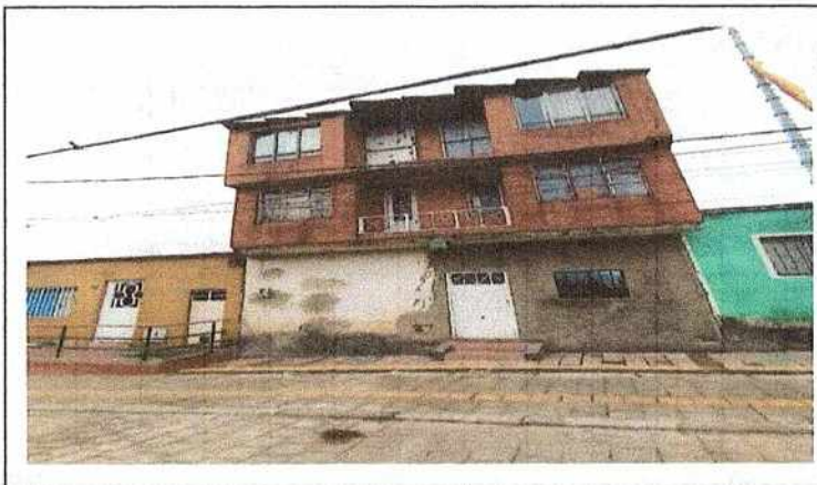
Foto No 8 Descripción Paredes con retracción.
