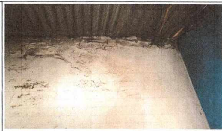
Foto No 2 Descripción: Muros con desprendimiento de material.
