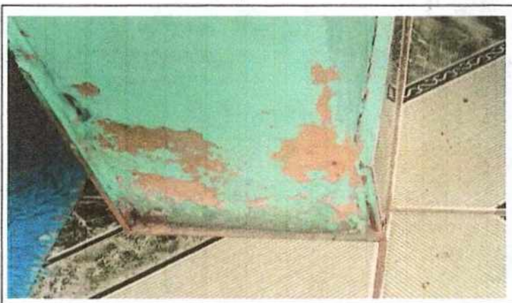
Foto No 4 Descripción Se evidencia desprendimiento de material por humedad
