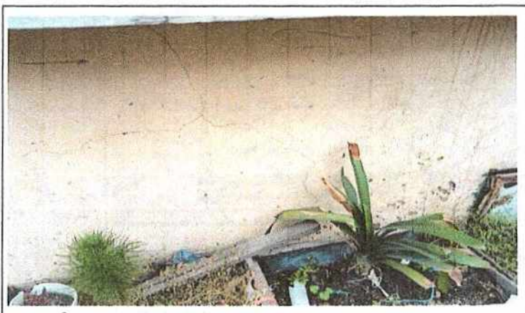
Foto No 7 Descripción Refracción en el pañete
