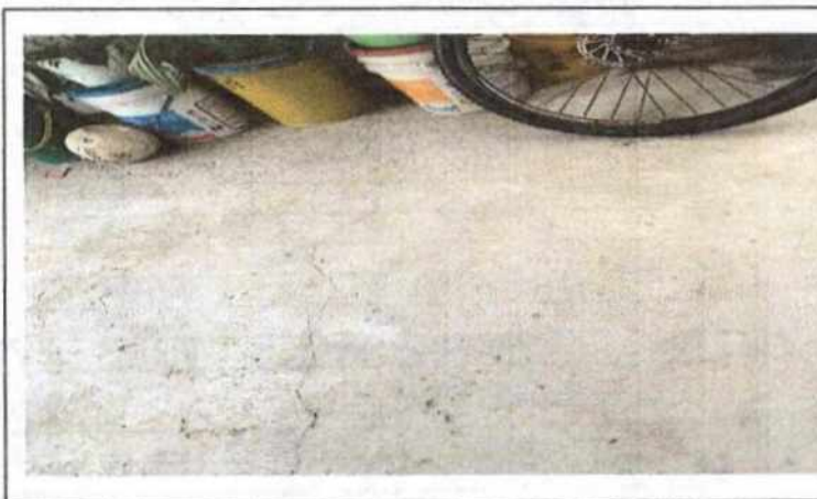
Foto No 4 Descripción Se evidencia fisura en piso de 2ml. por mal material
