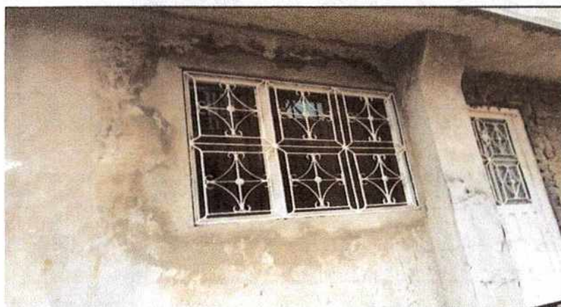
Foto No. 7 Descripción se evidencia humedad en muro
