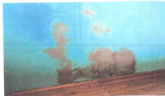
Foto No 2 Descripción Muros con humedad y fisuras
