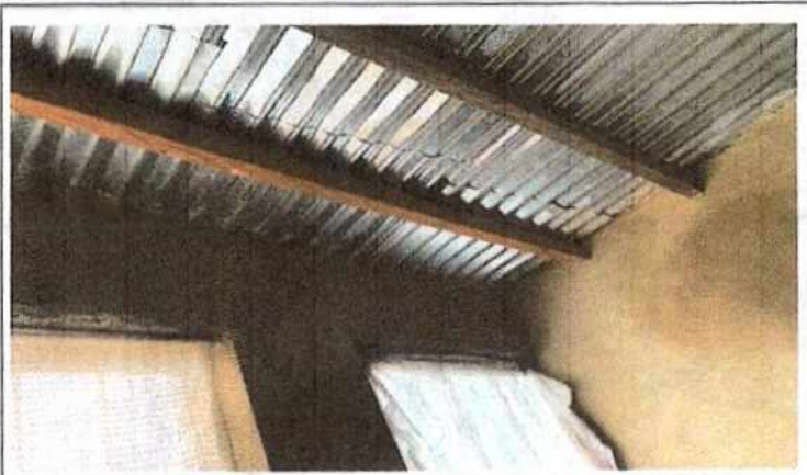
Foto No 1 Descripción Mujo con humedad
