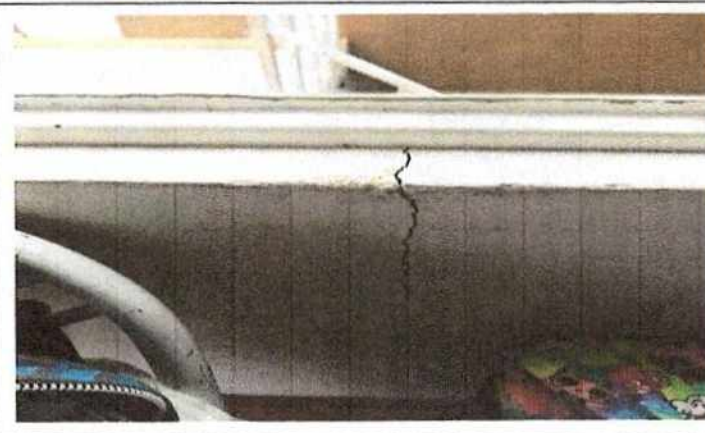
Foto No 8 Descripción agrietamiento en antepecho
