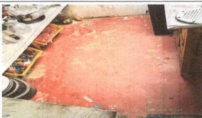
Foto No 7 Descripción Piso en cemento con desgaste por uso
