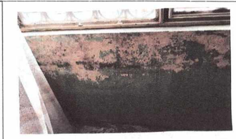
Foto No 2 Descripción Se evidencia humedad en muro de ventana
