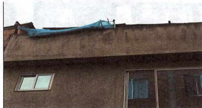
Foto No. 8 Descripción Se evidencia humedad en muro
