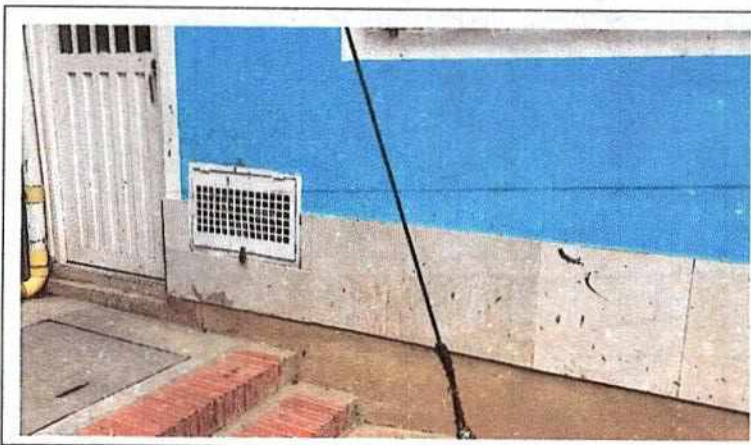
Foto No 3 Descripción Muros con fisuras y desprendimiento de material.
