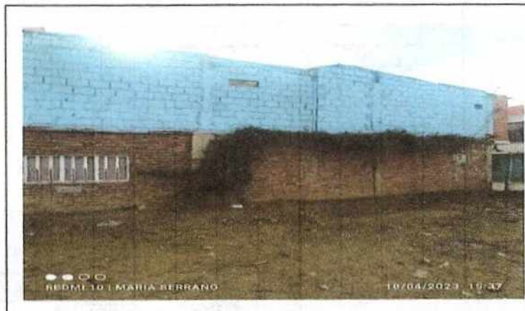
Foto No 4 Descripción Fachada en ladrillo y bloque con capa vegetal sobre puerta
