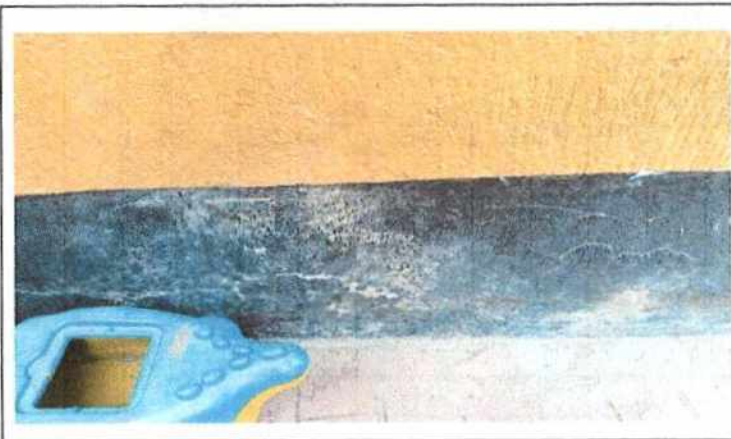
Foto No 8 Descripción Huio con humedad
