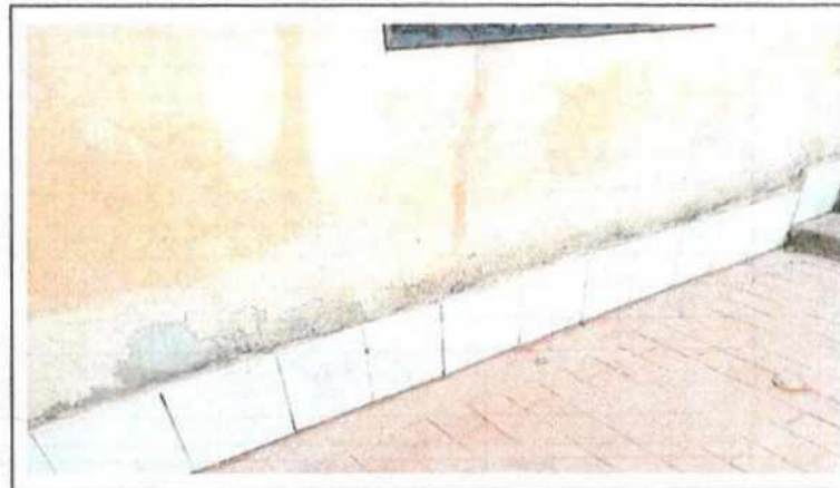
Foto No 4 Descripción Muro con humedad
