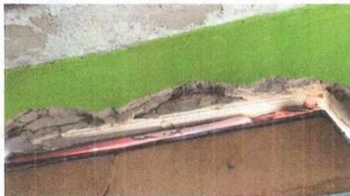
Foto No. 5 Descripción pérdida de material en marco de puerta de ingreso
