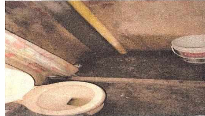
Foto No 4 Descripción se evidencia humedad pronunciada en baño
