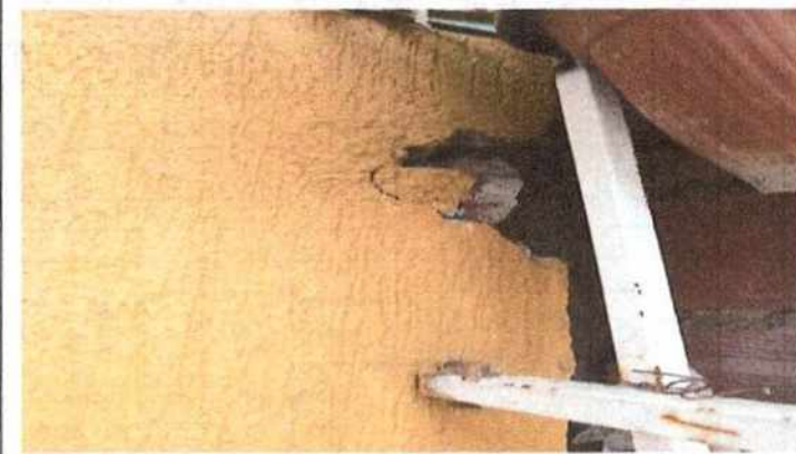
Foto No 2 Descripción Desprendimiento de material
