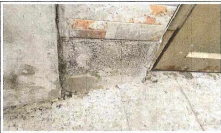
Foto No 3 Descripción Muro con presencia de humedad y moho
