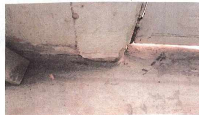
Foto No 2 Descripción Muros en parte con fisuras y desprendimiento de material
