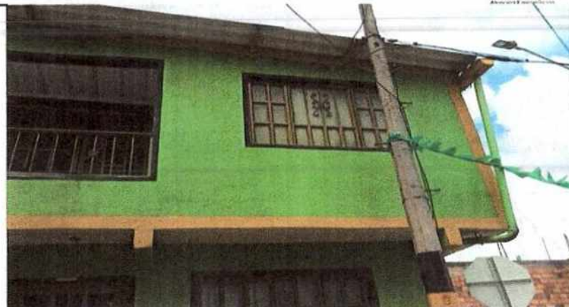
Foto No 6 Descripción fachada en buen estado
