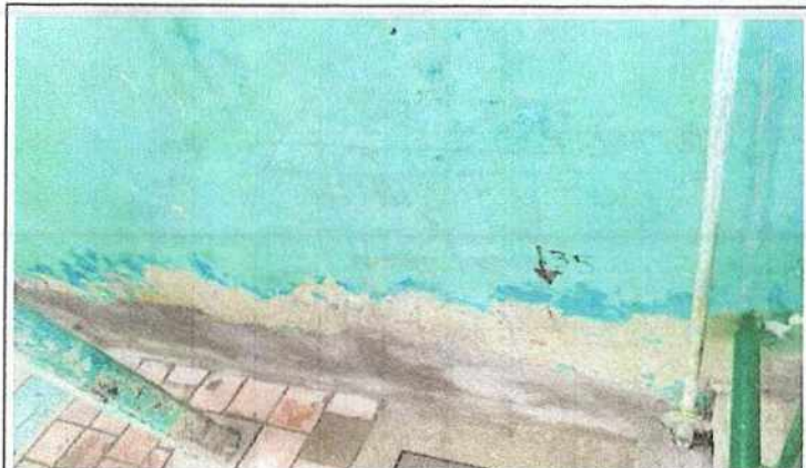
Foto No 1 Descripción Se evidencia pañete rematado sobre pintura sobre pañete
