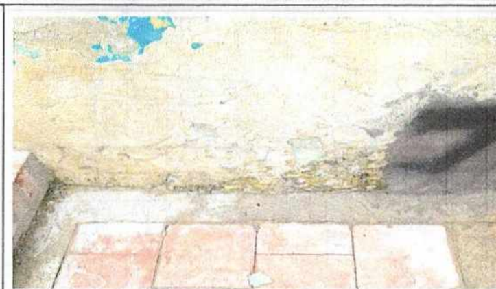
Foto No 2 Descripción Se evidencia remache
