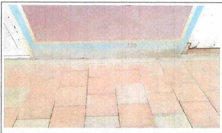
Foto No 5 Descripción Fluro con humedad.
