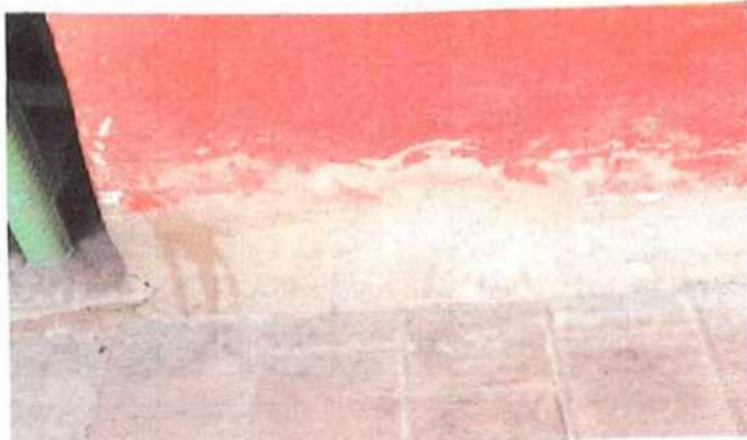
Foto No. 1 Descripción Piso en baldosa en buen estado parte con fisuras
