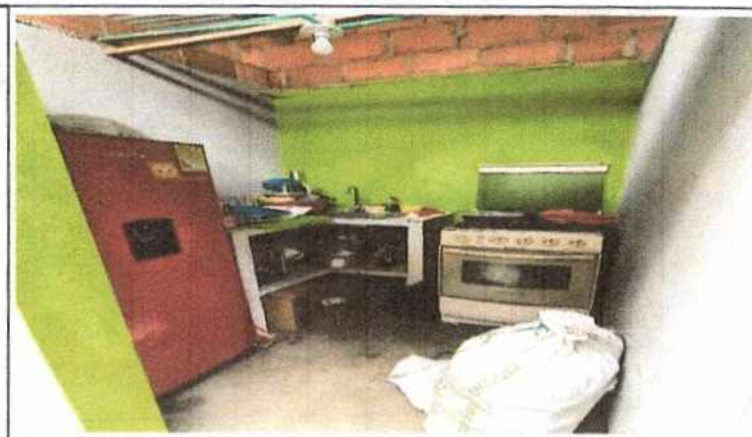
Foto No 6 Descripción Piso en cemento con desgaste por uso
