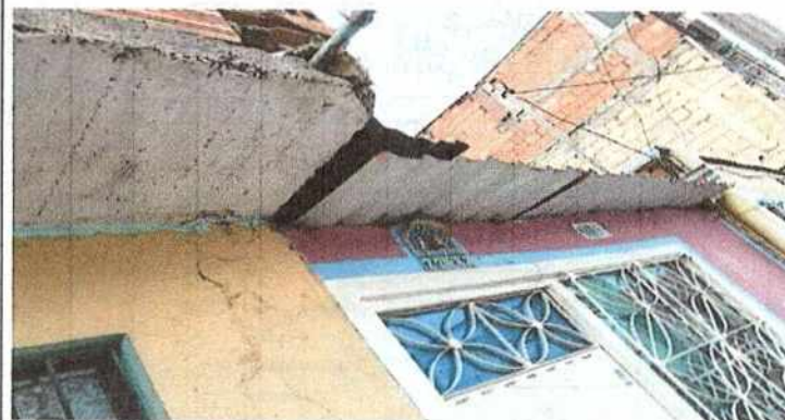
Foto No 2 Descripción Placa con desprendimiento de material
