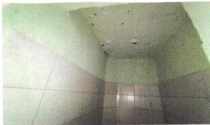
Foto No 7 Descripción Techo con presencia de humedad parte superior y desprendimiento de material
