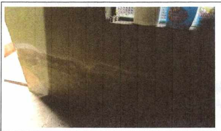
Foto No. 7 Descripción Se evidencia humedad en muro
