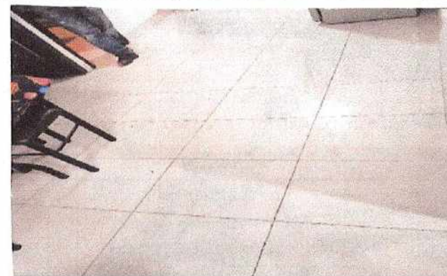
Foto No 4 Descripción puiso en baldosa en buen estado
