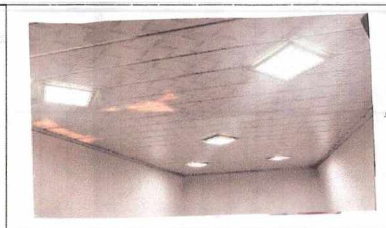
Foto No 2 Descripción Cubierta con desprendimiento de material
