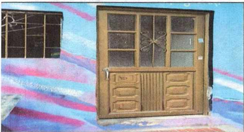
Foto No 7 Descripción Se evidencia desprendimiento de material en faja
