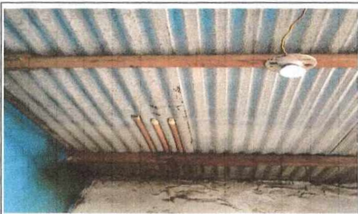
Foto No 3 Descripción: Cubierta en lamina zinc con oxidación.
