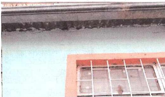
Foto No 8 Descripción Presunta mal embocillado entre muro y lamina de zinc
