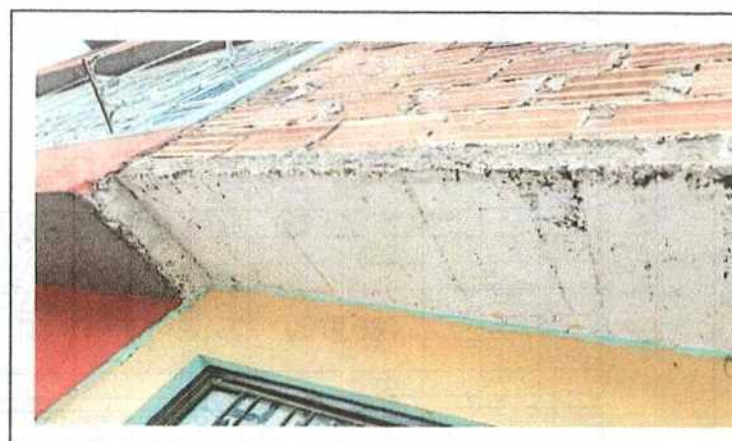
Foto No 4 Descripción Placa y muros con desgaste
