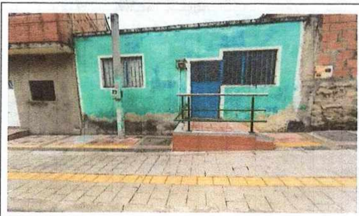
Foto No 3 Descripción Se evidencia fachada del predio con diferentes remaches
