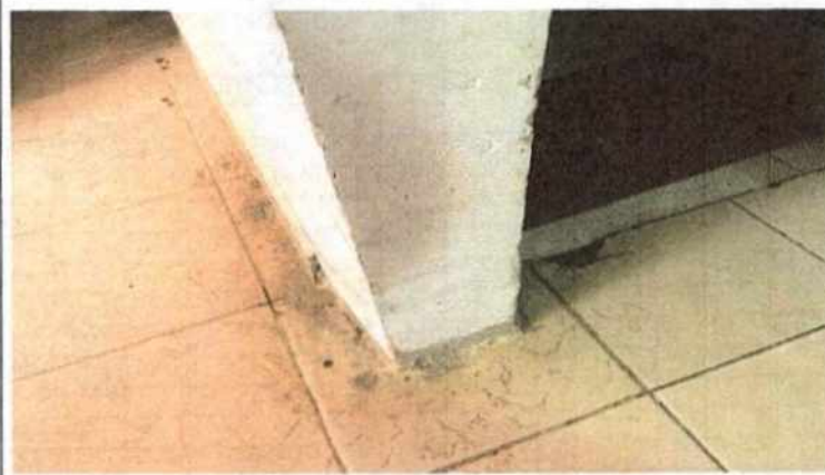
Foto No 1 Descripción Se evidencia desprendimiento de material en muro y piso
