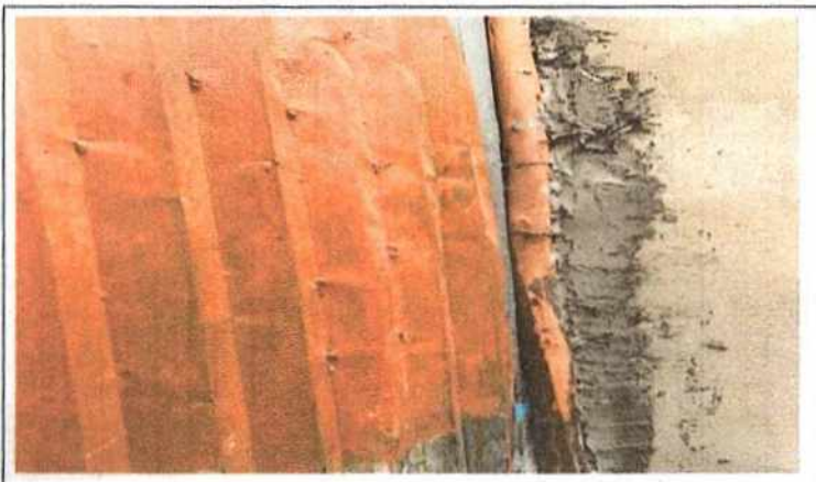
Foto No 5 Descripción Muro con parte superpuestas lamina con porosidad.
