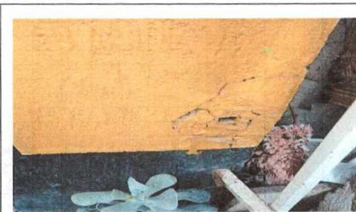
Foto No 4 Descripción Muro con agrietamiento
