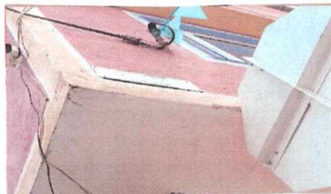
Foto No. 2 Descripción Pared en medio con fisura y desprendimiento de material
