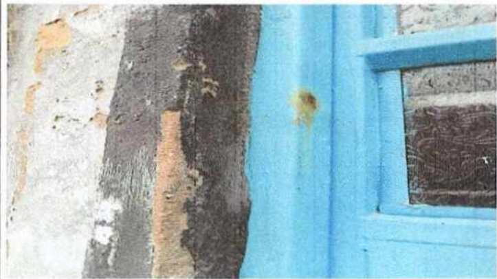
Foto No 3 Descripción se evidencia desprendimiento de material
