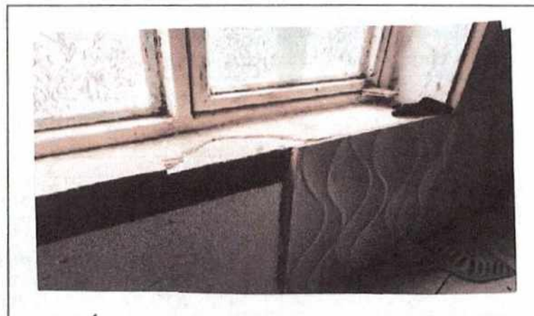
Foto No 4 Descripción Se evidencia chera en falses de ventana.
