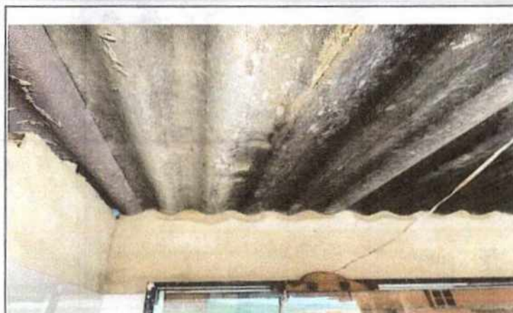
Foto No 1 Descripción Cubierta en leja eternit con humedad.
