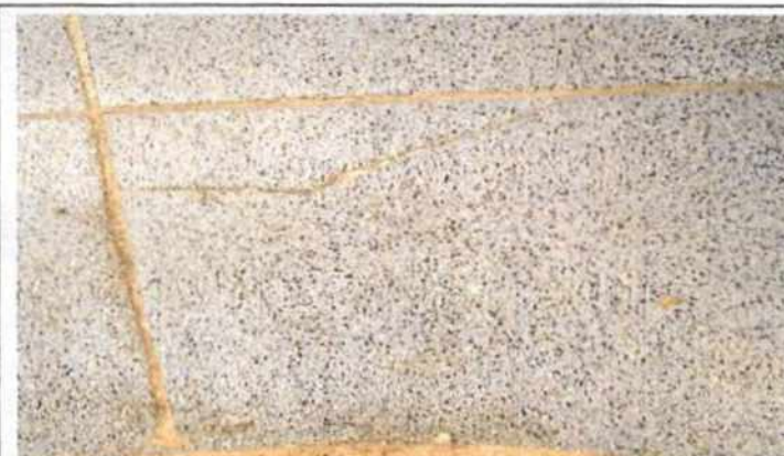
Foto No 8 Descripción Piso en baldosa fisurado.
