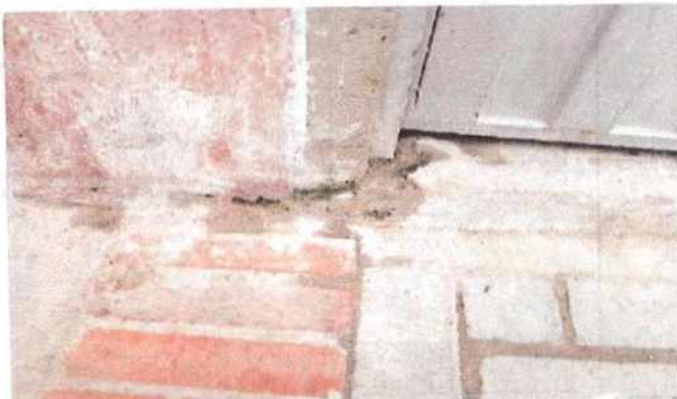
Foto No 5 Descripción se evidencia humedad en pisos
