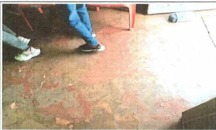
Foto No 1 Descripción Pisos en cemento con desgaste
