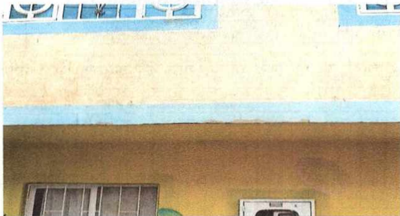
Foto No 1 Descripción Se evidencia deterioramiento en faja de material
