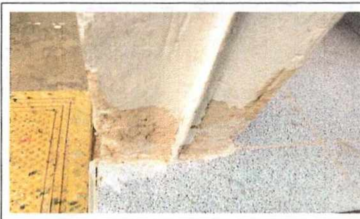
Foto No 4 Descripción Desprendimiento de material
