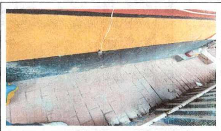
Foto No 3 Descripción Muro con humedad
