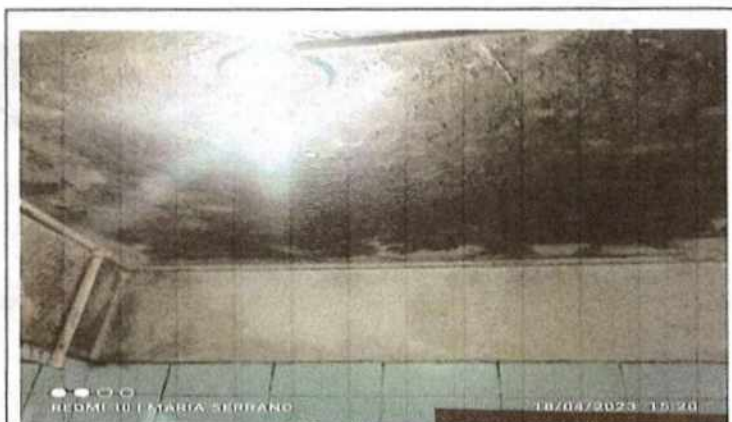
Foto No 7 Descripción se evidencia humedad en cubierta
