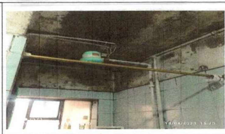
Foto No 2 Descripción se evidencia humedad a la vista
