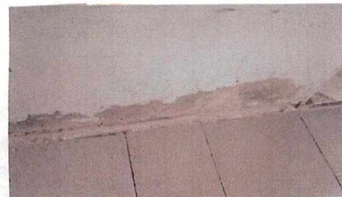
Foto No 4 Descripción Pared con humedad, fisuras
