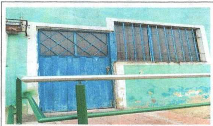
Foto No 7 Descripción se evidencia carpintería metálica con oxidación y desgaste en pintura
