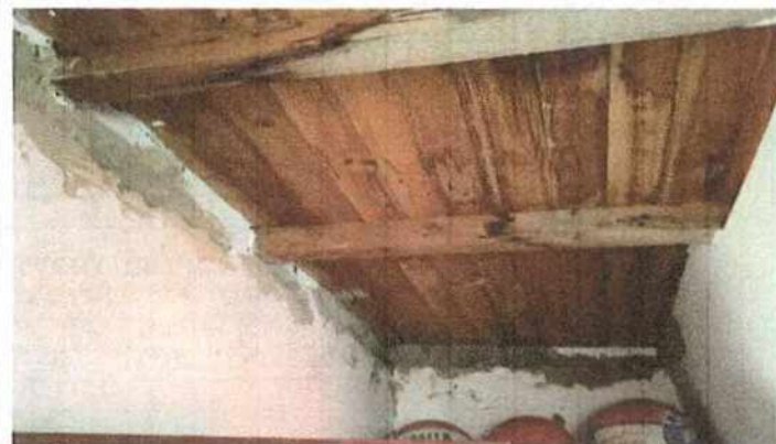
Foto No 2 Descripción Se evidencia remaches en pañete sobre muro
