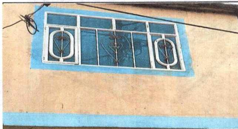
Foto No. 6 Descripción se evidencia vidrios averiados.
