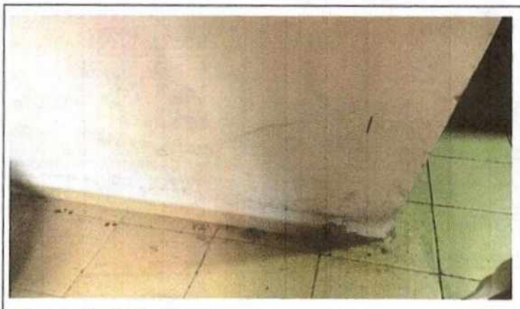
Foto No. 7 Descripción desprendimiento de material en filos
