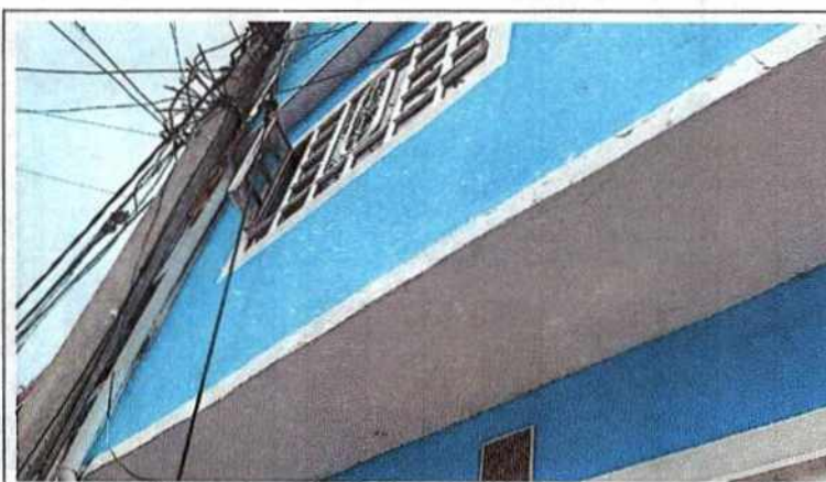
Foto No 8 Descripción Poste telefonos pegado a la vivienda.
