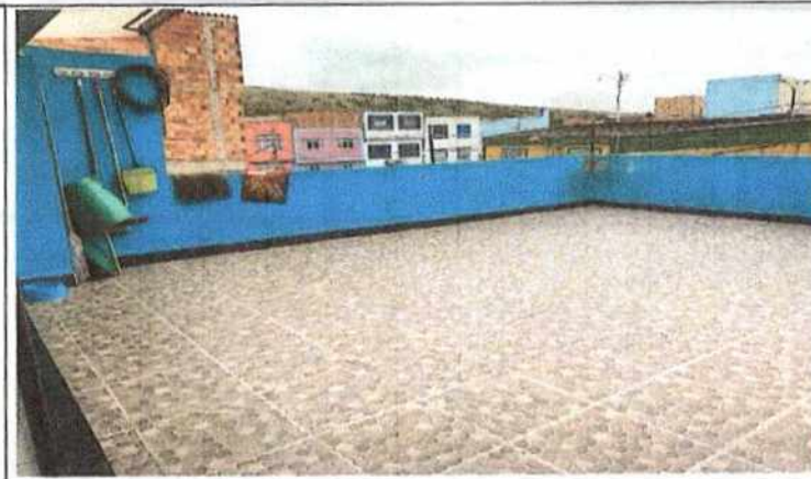
Foto No 6 Descripción Se evidencia piso y muros de terraza, muro con humedad piso en buen estado
