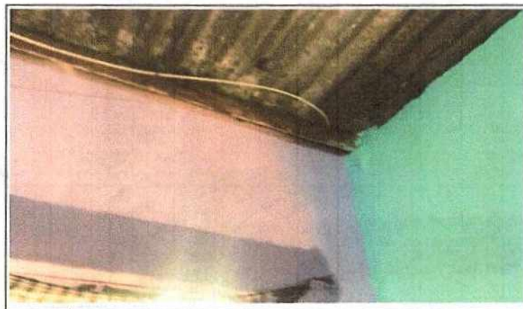
Foto No 4 Descripción Cubierta en teja eternit con humedad.
