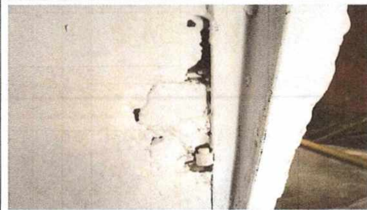
Foto No. 6 Descripción Se evidencia ausencia de material en muro
