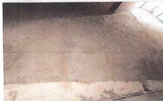
Foto No 2 Descripción se evidencia humedad en muro.
