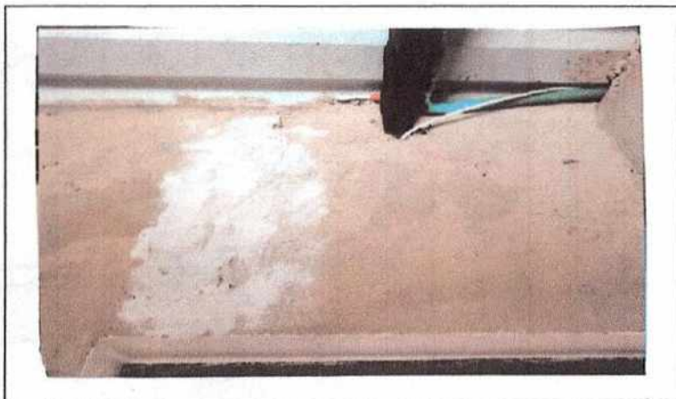
Foto No. 7 Descripción: se evidencia remache sobre muro
