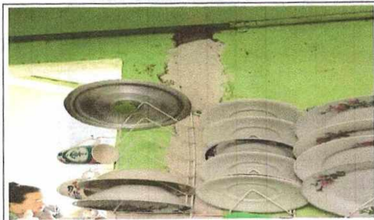
Foto No 7 Descripción Muros con estuco sobre pañete y retracción en el pañete.
