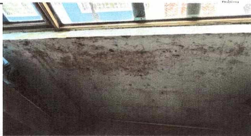
Foto No 6 Descripción Se evidencia humedad en cubierta
