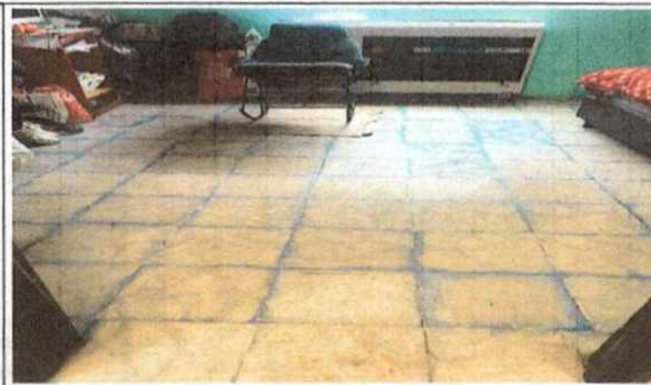
Foto No 6 Descripción Pisos en balcón con desgaste por uso
