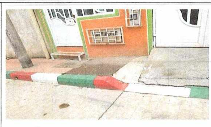
Foto No 6 Descripción Muros con humedad
