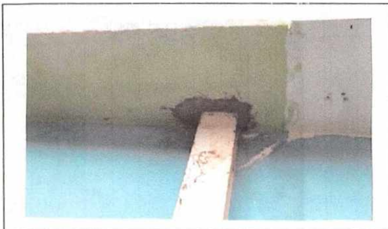
Foto No 1 Descripción Columna con presencia de fisura y nail remanece contra Techo, desplazamiento lateral
