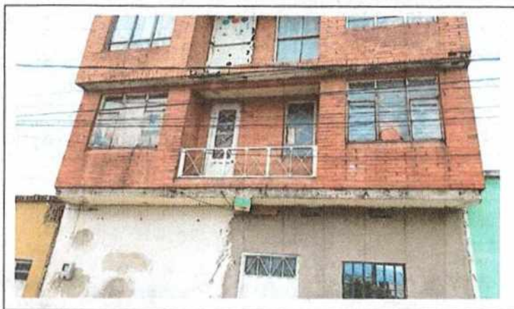
Foto No 1 Descripción: Humedad en ladrillos con presencia de humedad.
