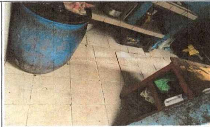
Foto No 6 Descripción Pisos en baldosa con desgaste por uso
