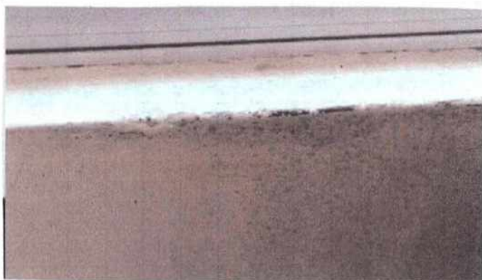
Foto No. 3 Descripción Desprendimiento de filoz.
