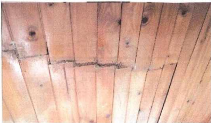
Foto No 1 Descripción Techo en machihembrado con malos uniones.
