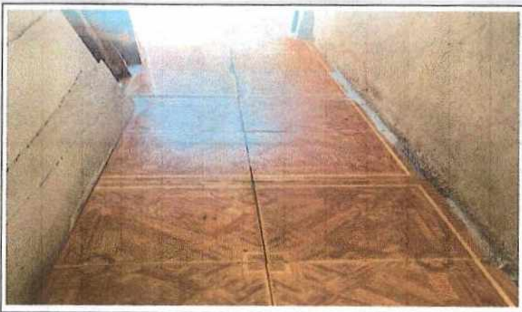
Foto No 1 Descripción Pisos en baldosa en buen estado y muros con retracción en paneles.
