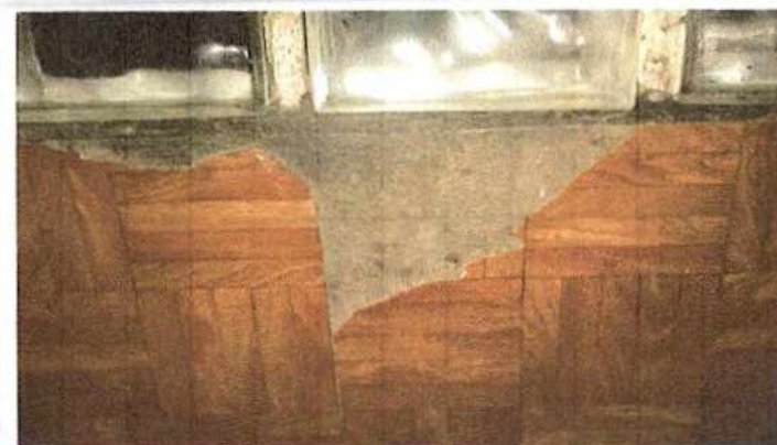
Foto No 6 Descripción piso con desprendimiento de material
