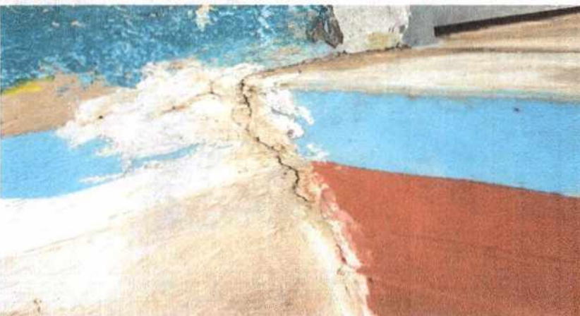
Foto No 2 Descripción se evidencia agrietamiento.
