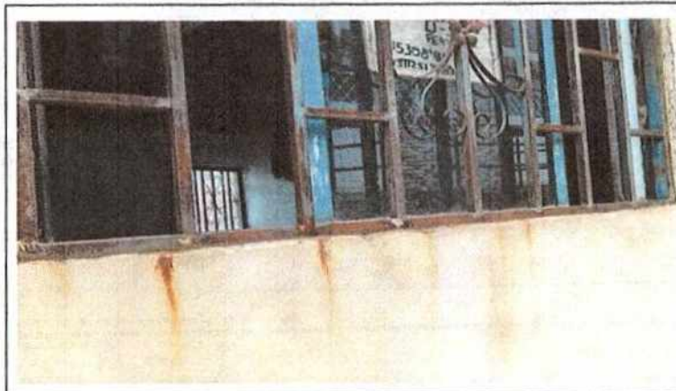
Foto No 8 Descripción: Carpintero metálico con presencia de oxidación.
