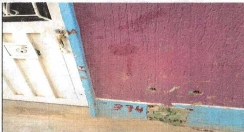
Foto No 3 Descripción Se evidencia pérdida de material en fides y muc
