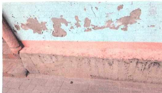
Foto No 7 Descripción Pintado con fisuras y desprendimiento de material
