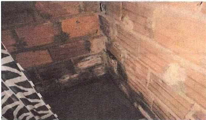
Foto No 1 Descripción Se evidencia humedad en bloques de muro
