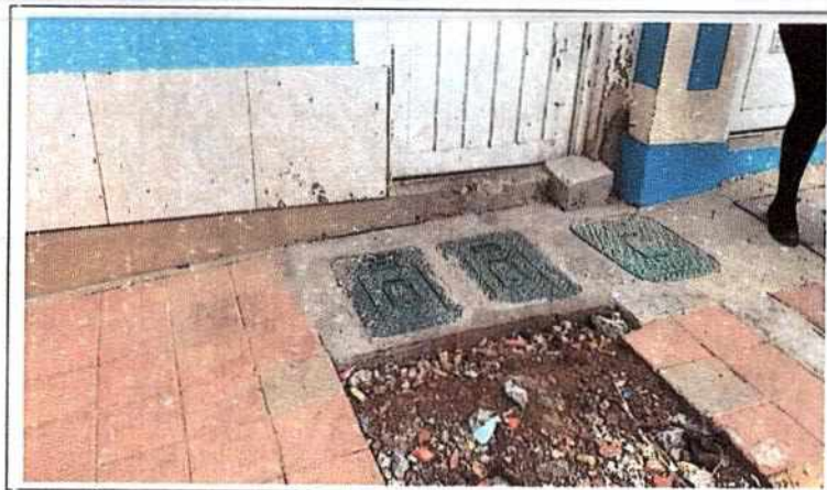
Foto No 1 Descripción Pisos en loseta con perdida de varias Pieza
