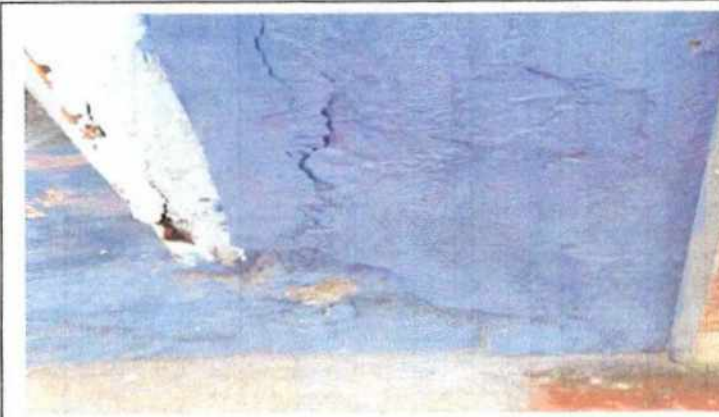
Foto No. 8 Descripción Desprendimiento de material (pintura)
