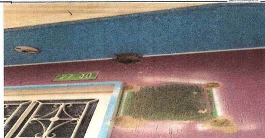
Foto No. 6 Descripción Se evidencia reparcho en muro
