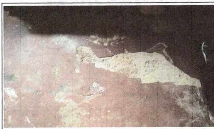
Foto No 8 Descripción M. Piso en cemento con desprendimiento de material.
