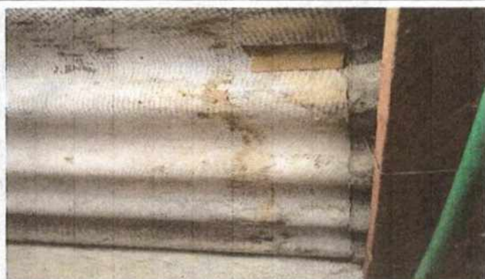
Foto No 5 Descripción Cubierta en presencia de humedad.
