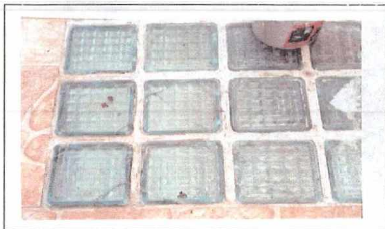
Foto No 1 Descripción Piso con fisuras
