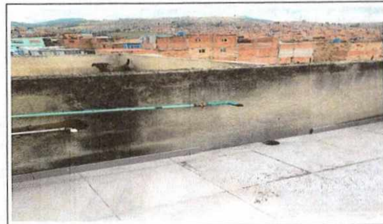
Foto No 4 Descripción Mpo antepecho con presencia de humedad
