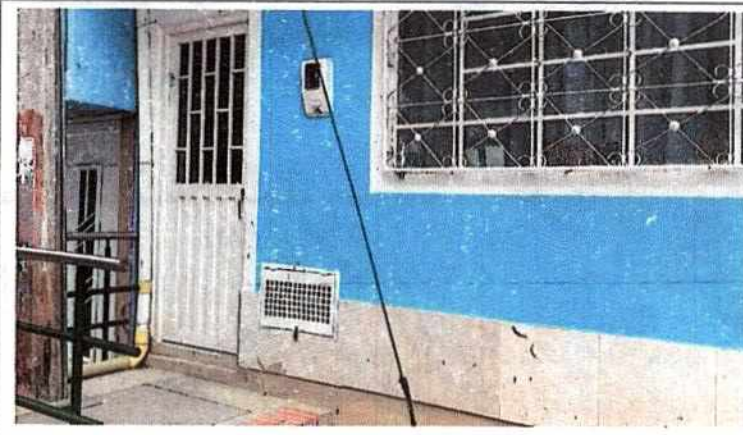
Foto No 2 Descripción Muro fisurado con desprendimiento de material
