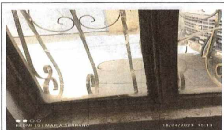
Foto No 5 Descripción se evidencia curva en muro
