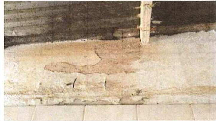
Foto No 2 Descripción se evidencia desprendimiento de material en muro
