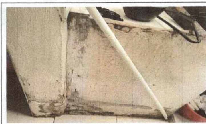
Foto No 7 Descripción Se evidencia humedad
