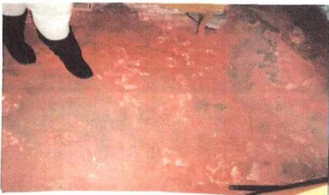
Foto No 1 Descripción Piso con fisura
