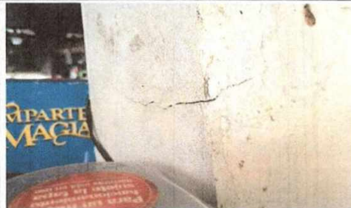
Foto No 6 Descripción Muros con fisuras
