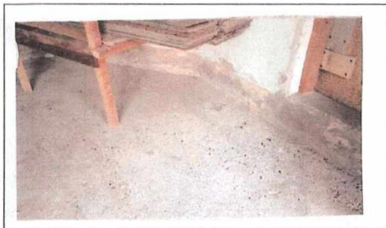
Foto No 3 Descripción Piso encimado con fisuras
