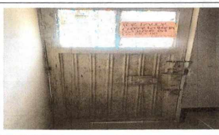
Foto No. 8 Descripción Puerta en desgaste de pintura
