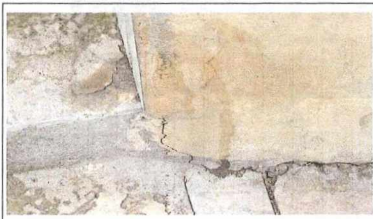
Foto No 7 Descripción: Muro con agrietamiento y presencia de humedad.
