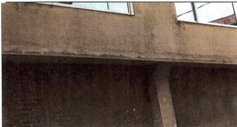
Foto No 1 Descripción Se evidencia desprendimiento de material
