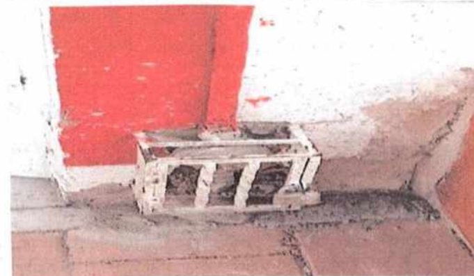
Foto No. 4 Descripción Pared con fisuras y desprendimiento
