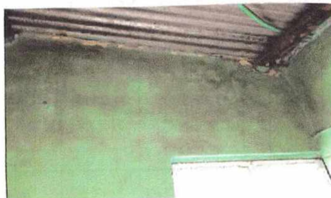
Foto No 4 Descripción Muro con fisuras, moho, y humedad
