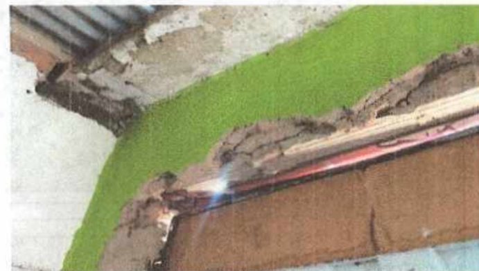
Foto No. 6 Descripción puerta de ingreso no cuenta con vidrios.
