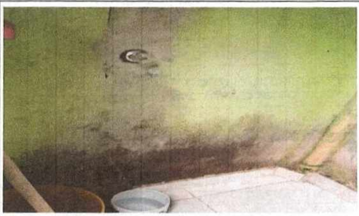
Foto No 3 Descripción Muro con presencia de humedad
