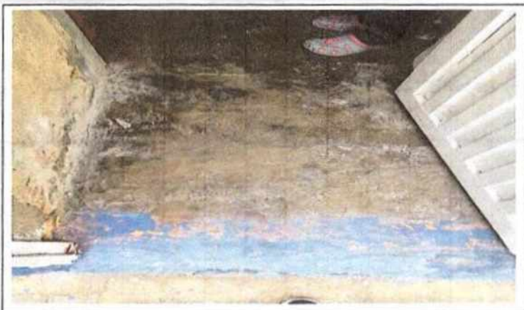
Foto No. 5 Descripción Pisos en cemento con desgaste
