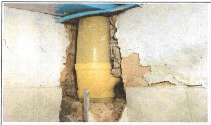
Foto No 3 Descripción Se evidencia perdida de material por humedad y tubería pvc
