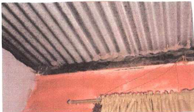
Foto No 5 Descripción Muro con fisuras y desprendimiento de material.
