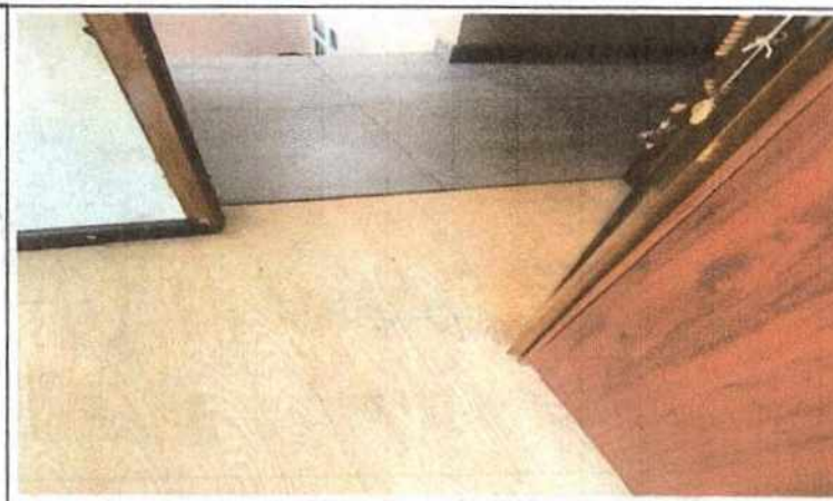
Foto No 6 Descripción Unión de acabados con desnivel.
