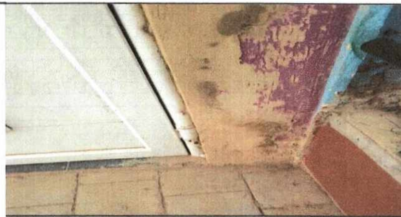
Foto No 2 Descripción Se evidencia desprendimiento de material y repelido
