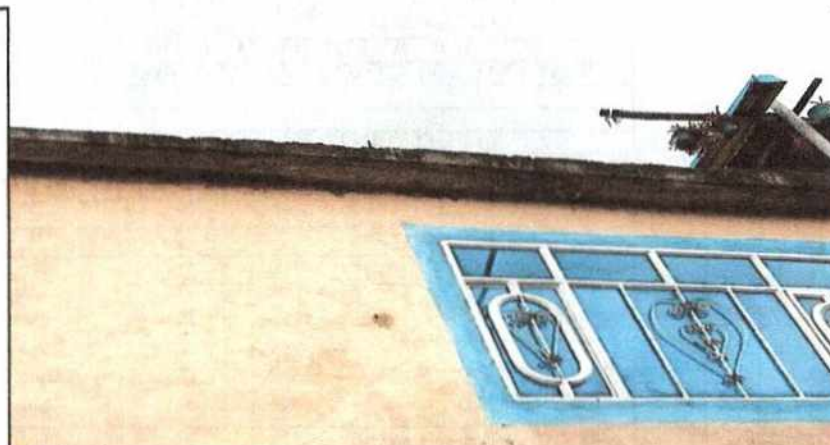
Foto No 3 Descripción se evidencia presencia de humedad
