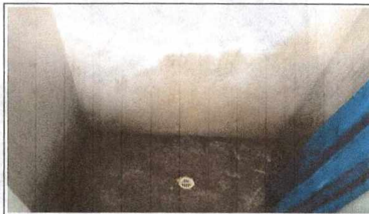
Foto No 8 Descripción Piso y muros con presencia de humedad.
