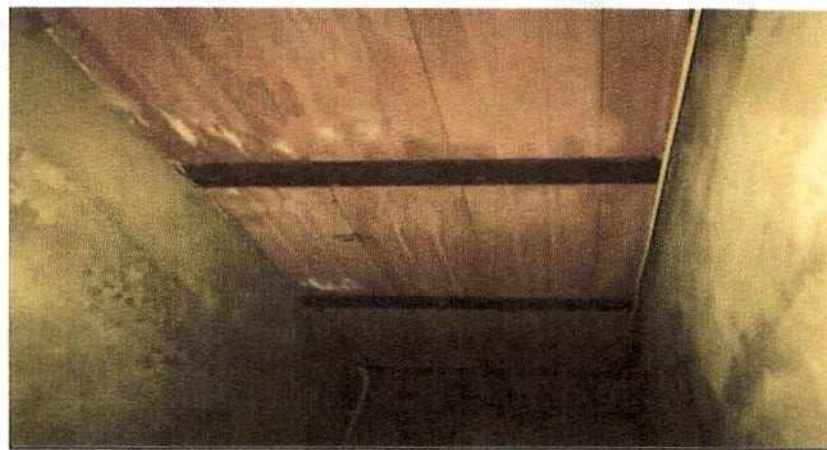
Foto No 8 Descripción presencia de humedad en muro
