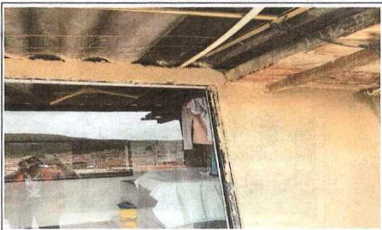
Foto No 5 Descripción Dilatación entre muro y marco de puerta.
