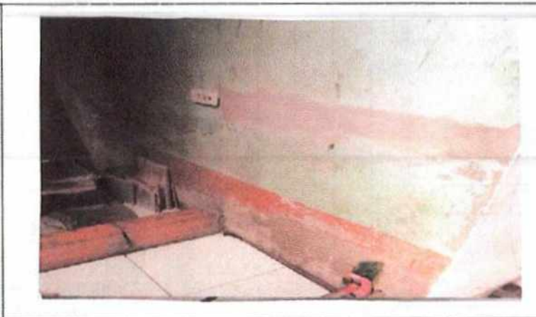
Foto No 6 Descripción Se evidencia desgaste en pintura
