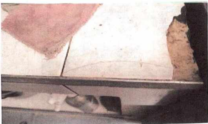
Foto No. 7 Descripción Mesa cocina con fisura, baldosas rota y desprendido
