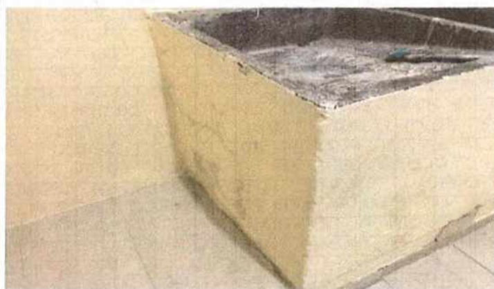
Foto No 3 Descripción Muro con retracción y humedad
