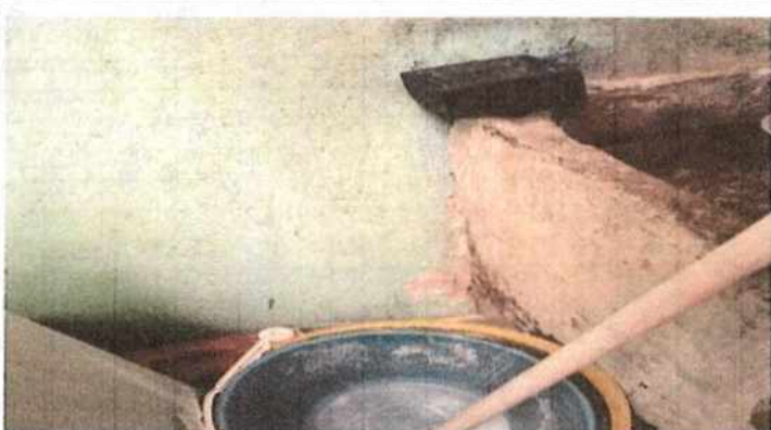
Foto No 3 Descripción Se evidencia lavadero con humedad muro con humedad
