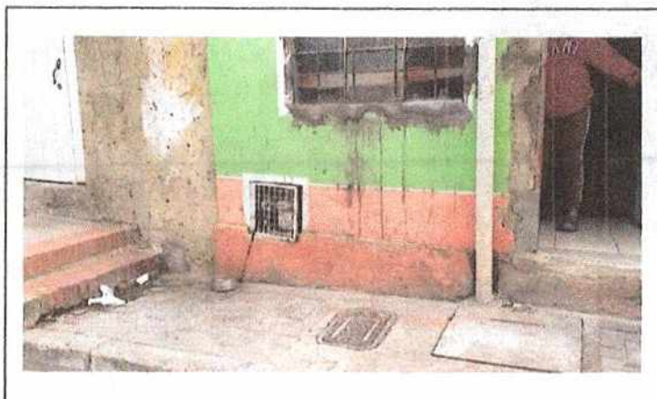
Foto No 1 Descripción remate en filos de marco de ventana
