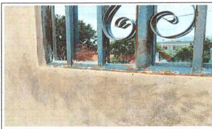
Foto No 4 Descripción: Carpintería metálica con oxidación
