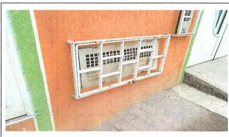
Foto No 8 Descripción Muro con presencia de humedad.
