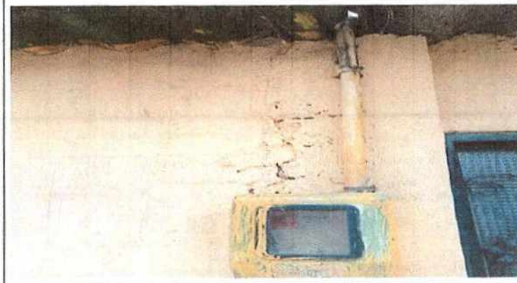
Foto No 6 Descripción: Muro con agrietamientos
