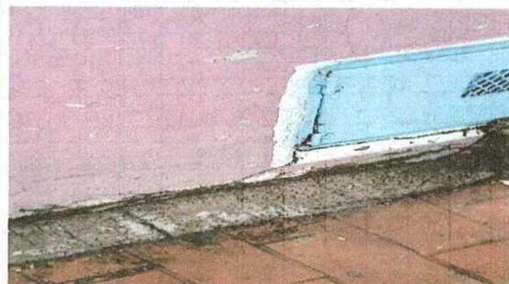
Foto No 1 Descripción Muro con humedad y agrietamiento
