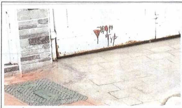
Foto No 1 Descripción: Carpintera metálica con oxidación
