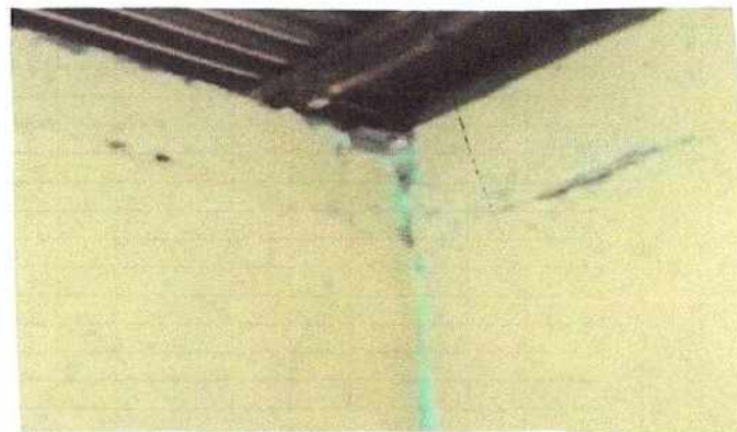
Foto No 6 Descripción Muro con fisuras, humedad y desprendimiento de material
