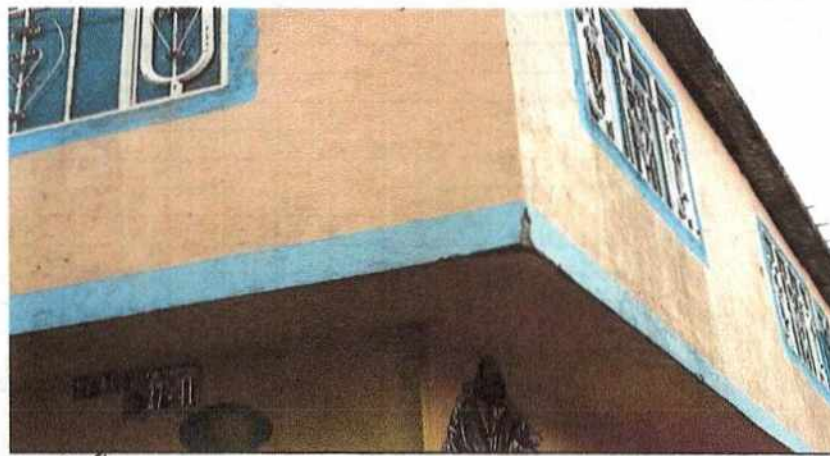
Foto No 4 Descripción se evidencia deterioramiento de material a la u/fq
