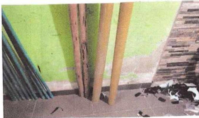
Foto No. 8 Descripción Pavimento con presencia de humedad, fisura y desprendimiento material.
