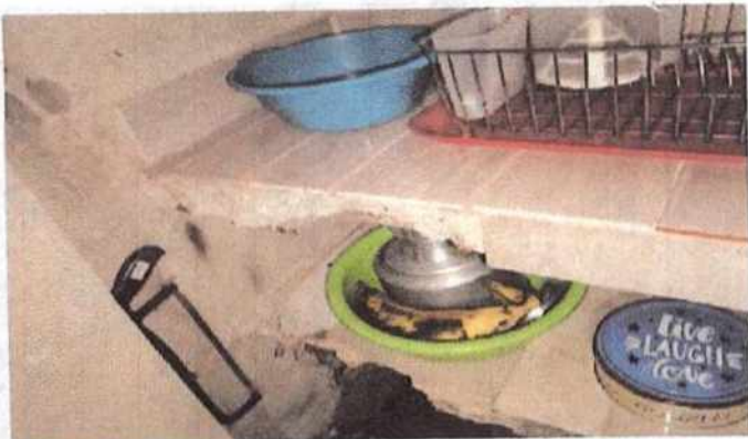
Foto No 7 Descripción Se evidencia desprendimiento de material en mesón
