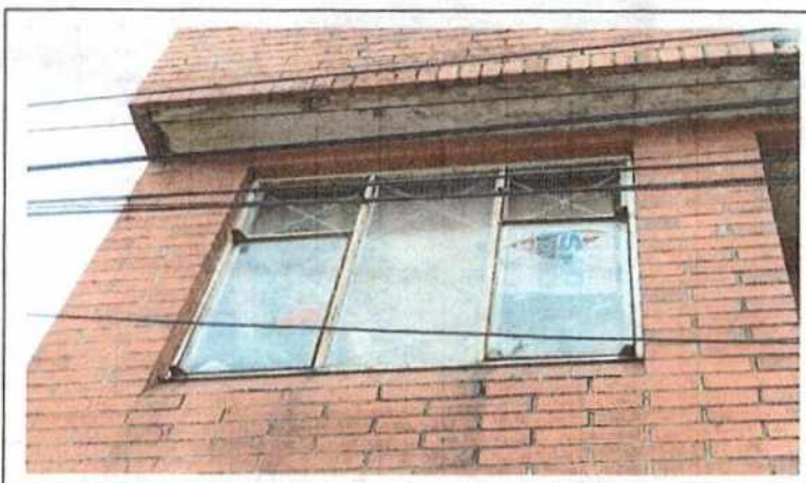
Foto No 3 Descripción: Vidrios averiados
