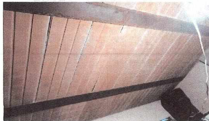
Foto No 2 Descripción Se evidencia abisma en placa faja con presencia de humedad
