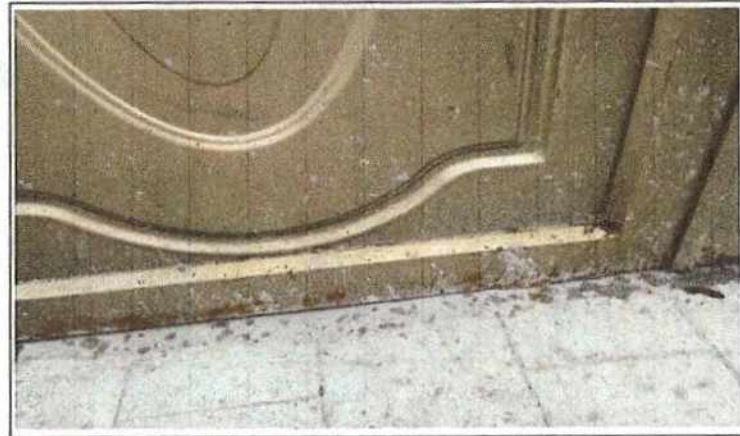
Foto No 8 Descripción Carpintería metálica en presencia de oxidación
