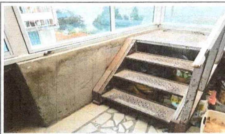
Foto No 4 Descripción se observa escalera metálica es estado de oxidación.
