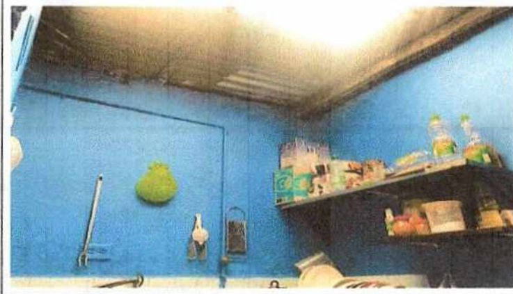
Foto No 2 Descripción Muros con refracción en el panel.
