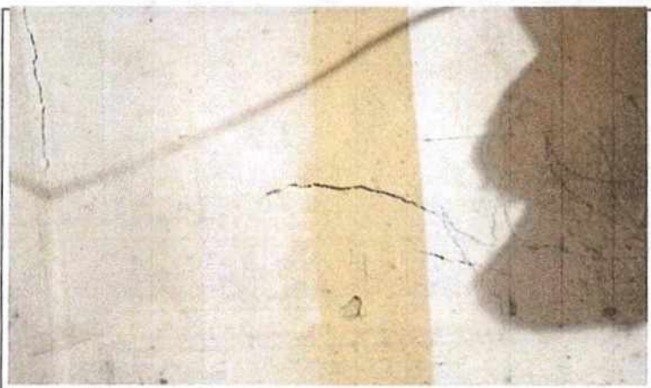
Foto No 1 Descripción Muro con agrietamientos
