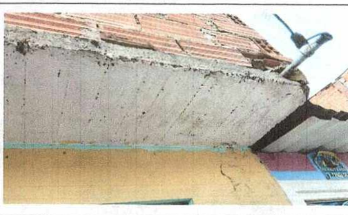
Foto No 3 Descripción Muros con fladuras y desprendimiento de material.
