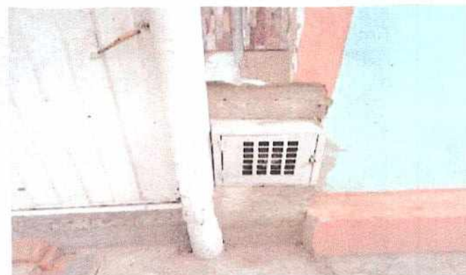
Foto No 6 Descripción Pavito muro con desprendimiento de material
