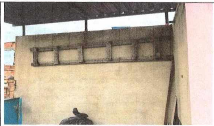
Foto No 2 Descripción Se observa muro con desprendimiento de material debido a la humedad.
