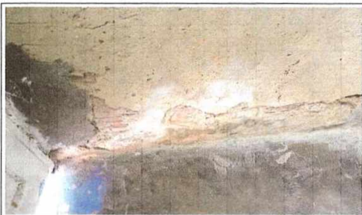
Foto No 1 Descripción Desprendimiento de pañete
