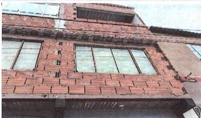
Foto No 1 Descripción se evidencia desprendimiento de material en muro.
