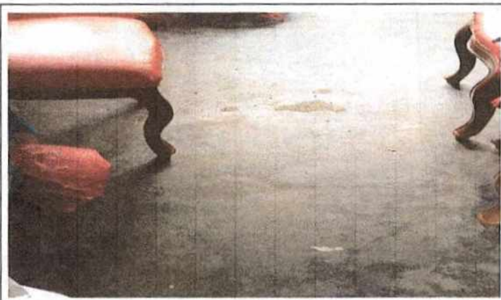
Foto No 5 Descripción Piso en cemento con desproporcionalidad de material.
