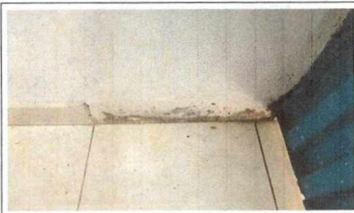
Foto No 5 Descripción Se evidencia desprendimiento de material
