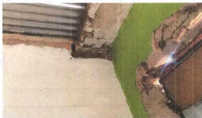
Foto No. 7 Descripción se evidencia entrada de luz entre marco y muro
