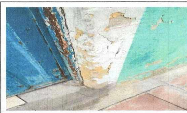
Foto No 8 Descripción se evidencia desprendimiento de material y óxido en la puerta.
