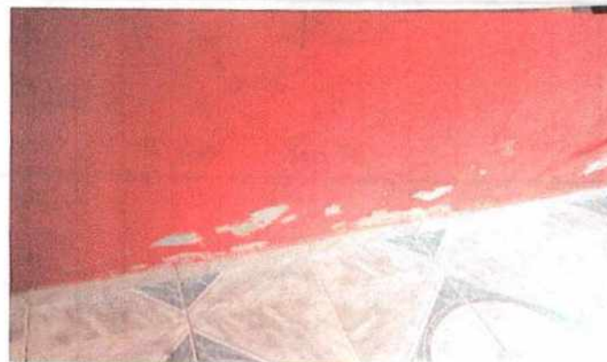
Foto No. 6 Descripción Pavimento con fisura y desprendimiento de material
