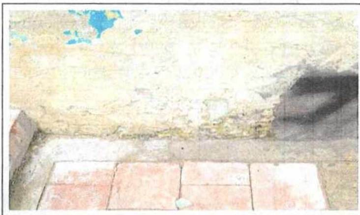
Foto No 5 Descripción se evidencia humedad en el andén
