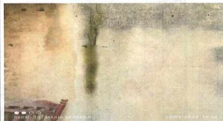
Foto No 6 Descripción se evidencia mancha de humedad
