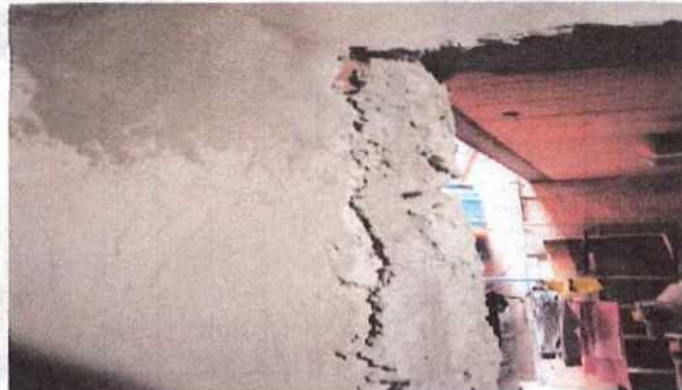
Foto No 8 Descripción Se evidencia desprendimiento de material en muro
