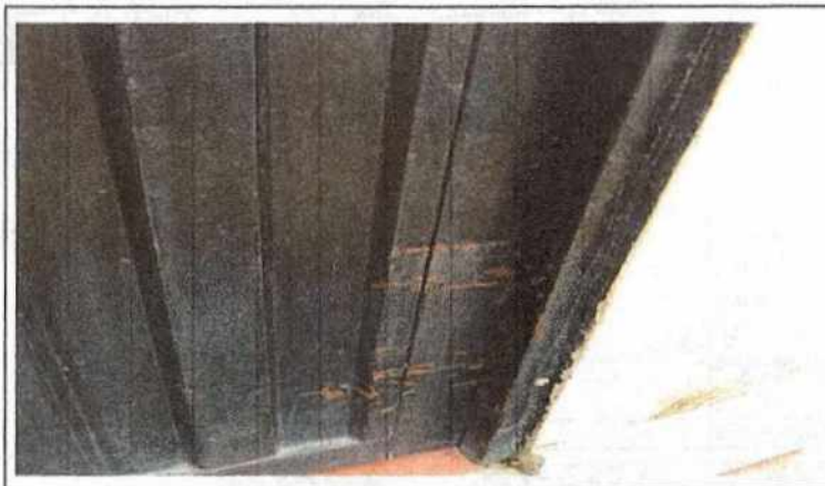
Foto No 3 Descripción Carpintería metálica con presencia de oxidación
