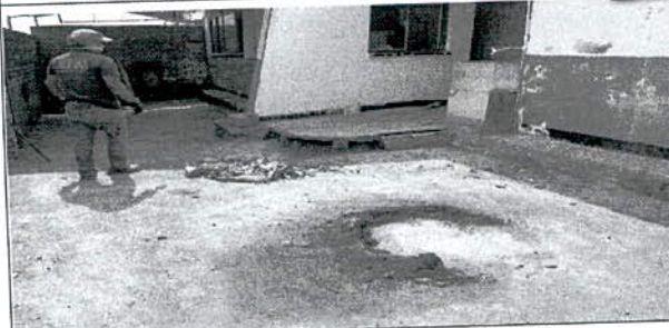
PISO PATIO EN MAL ESTADO
