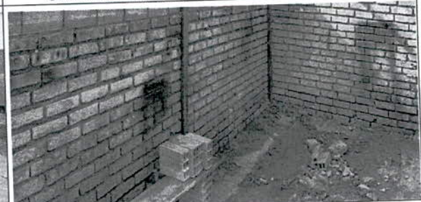
PISO PATIO EN MAL ESTADO
