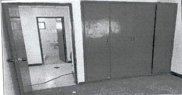
MAL ESTADO PINTURA PUERTAS Y CLOSED
