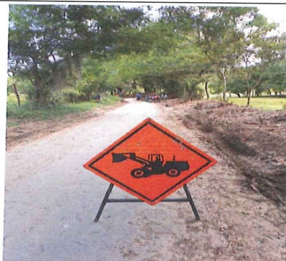
Señalización en la Vía
