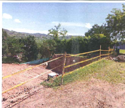
Señalización tanque de Almacenamiento
