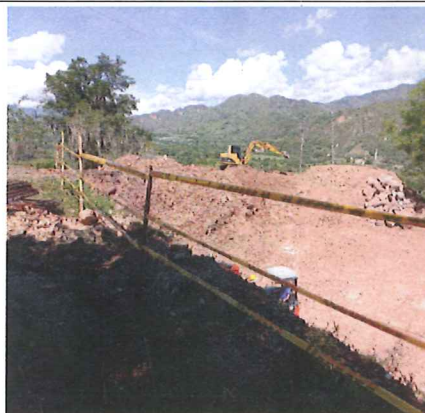
Señalización tanque de Almacenamiento
