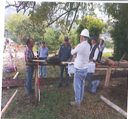
Comité técnico Aguas del huila, Solserving y Ut Pma Suaza Tanque de Almacenamiento
