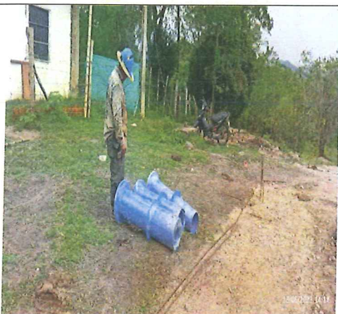
Pasamuros del tanque de almacenamiento
