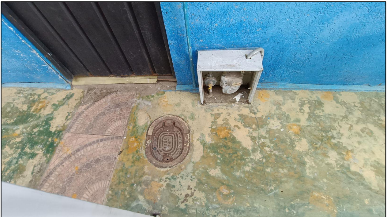
MEDIDOR DE ACUEDUCTO
