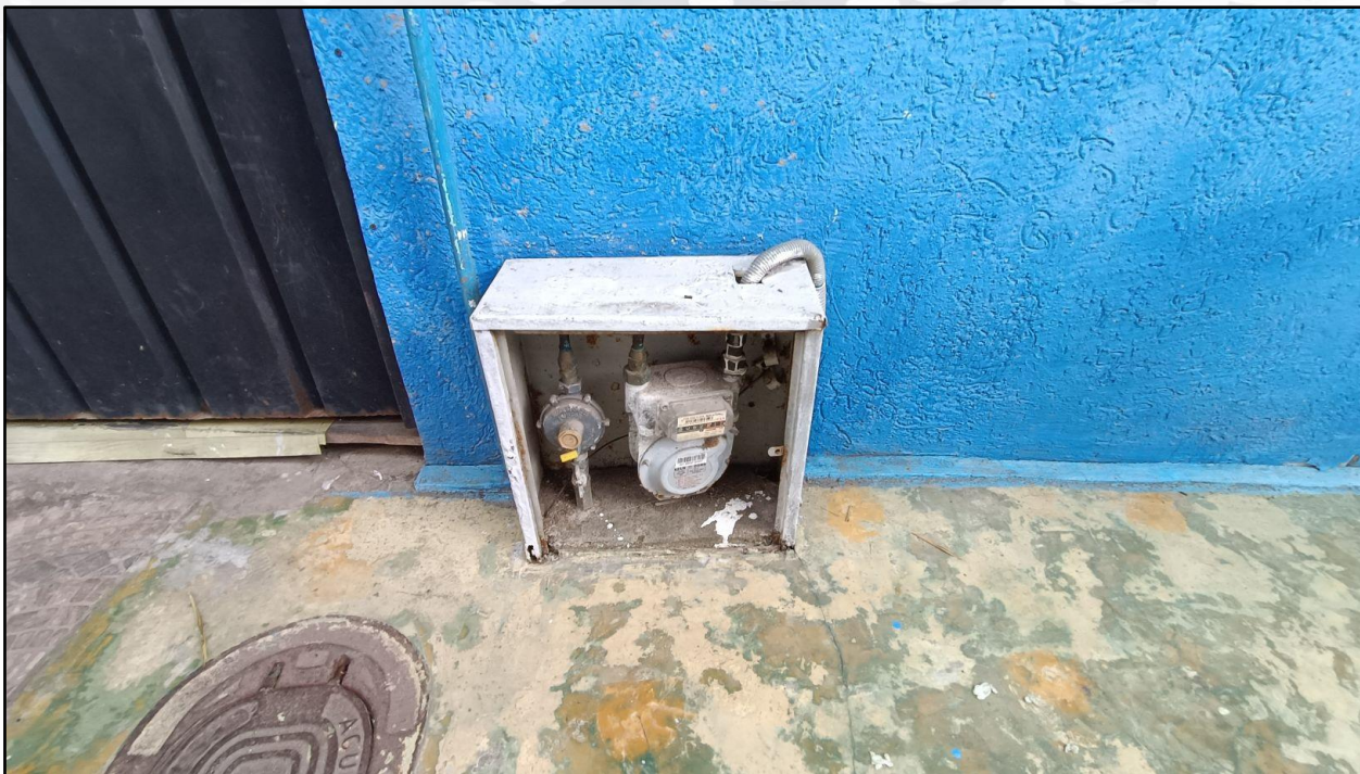
MEDIDOR DE GAS NATURAL
