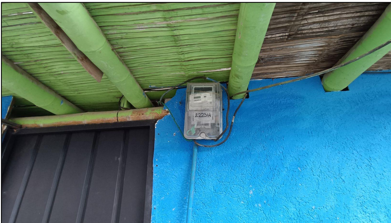
MEDIDOR DE ENERGIA ELECTRICA
