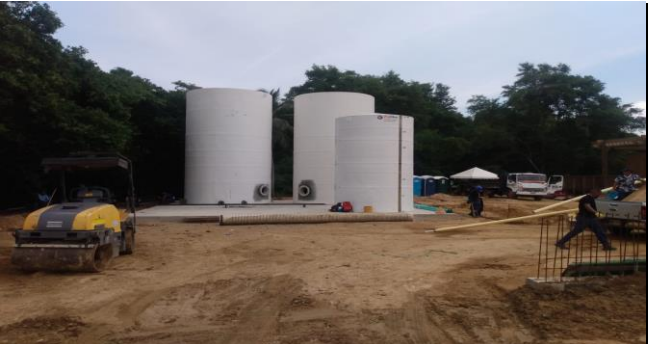
TANQUES DE AGUA POTABLE Y CONTRA INCENDIO
