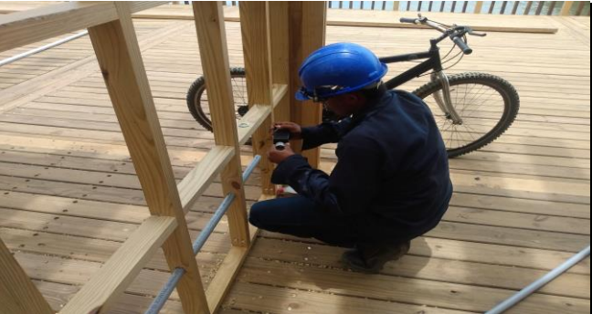
INSTALACIONES ELECTRICAS EDIFICIO LA PLAYITA
