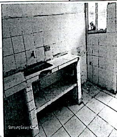
Cocina con enchape deteriorado
