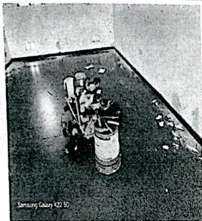
Falta de pintura en la parte interna
