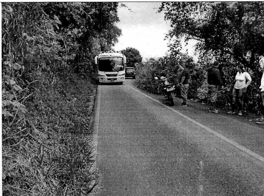
Foto #2. Perdida de banca K8+000, Cunday – Villarrica.
