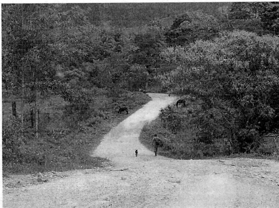
Foto #4. Afectación por paso de agua K28+700, Cunday – Villarrica.
