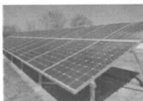
Sistemas Fotovoltaicos y sus componentes
