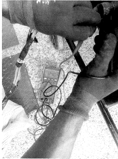
Toma de parametros en vacio (sin carga electrica)
