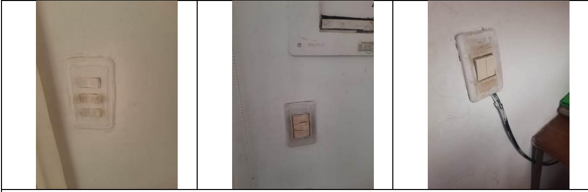
Interruptores en mal estado
