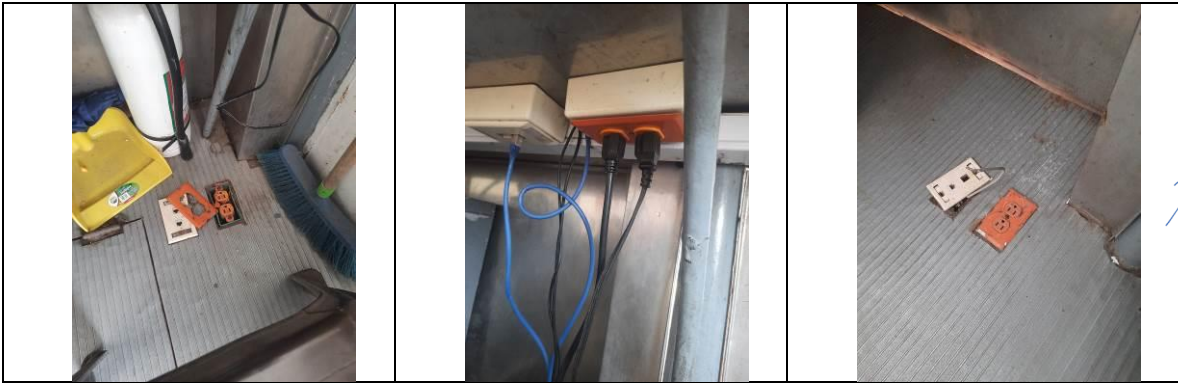
Tomacorrientes en mal estado
