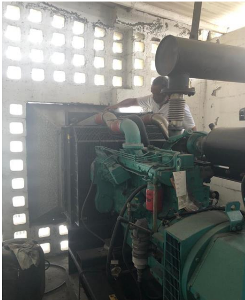
Imagen. Planta eléctrica del Centro Cultural “Guillermo Barney Materón”
