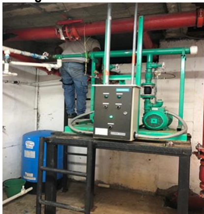
Imagen. Bomba centrífuga del Centro Cultural “Guillermo Barney Materón”
