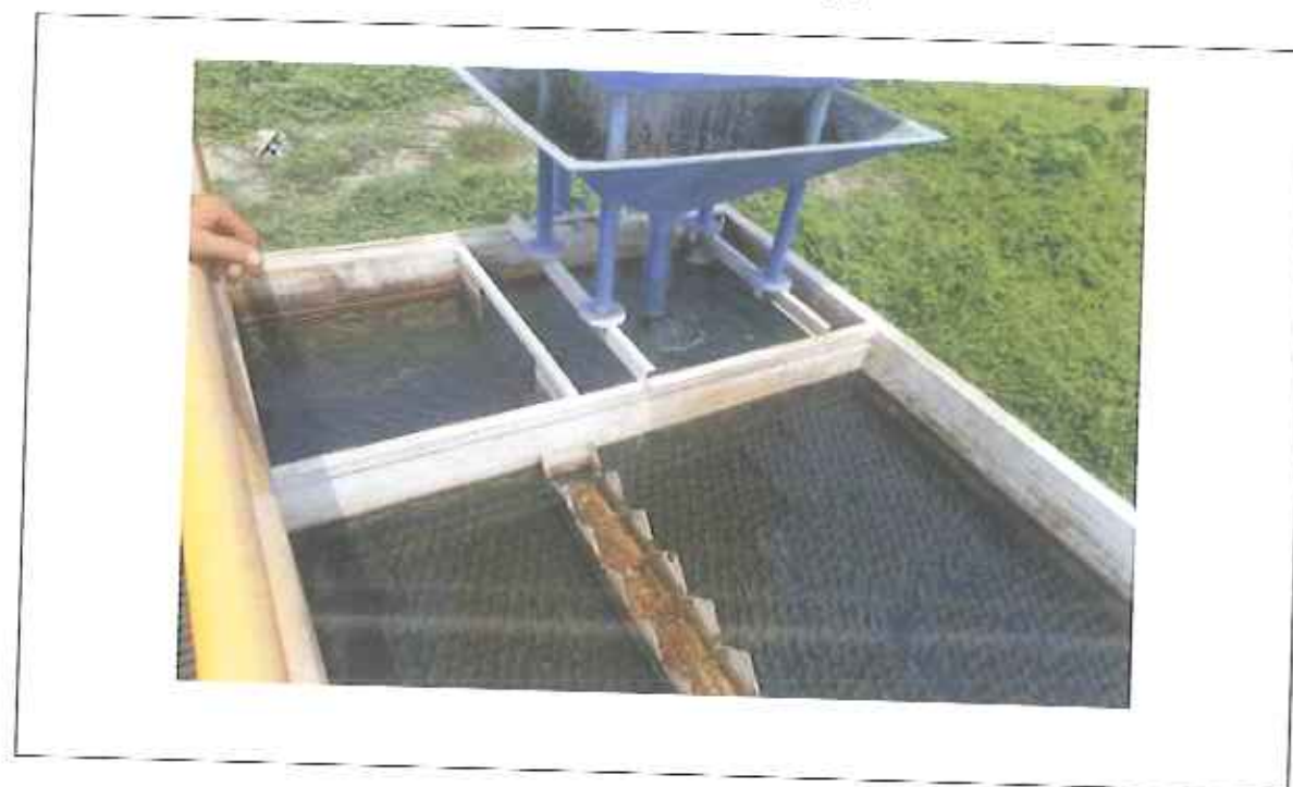
PLANTA DE TRATAMIENTO DEL AGUA PROVENIENTE DEL POZO PROFUNDO
