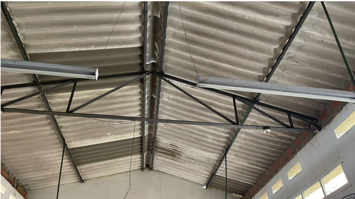
Fotografía No 3: Teja instalada en Eternit en mal estado lo cual genera goteras dentro del aula
