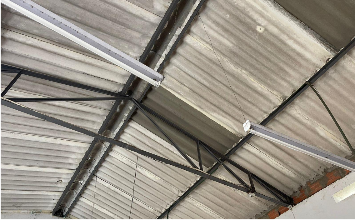
Fotografía No 2: Teja instalada en Eternit en mal estado lo cual genera goteras dentro del aula
