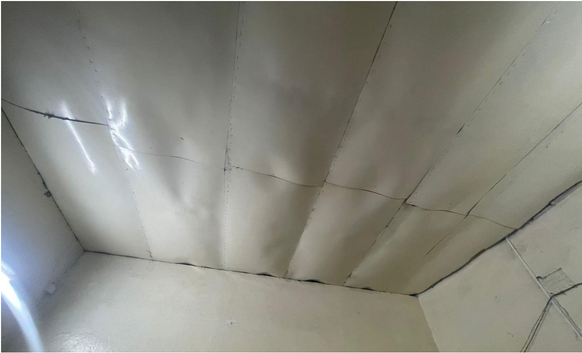
Fotografía No 6: Cieloraso en lamina de la sala de informatica en mal estado
