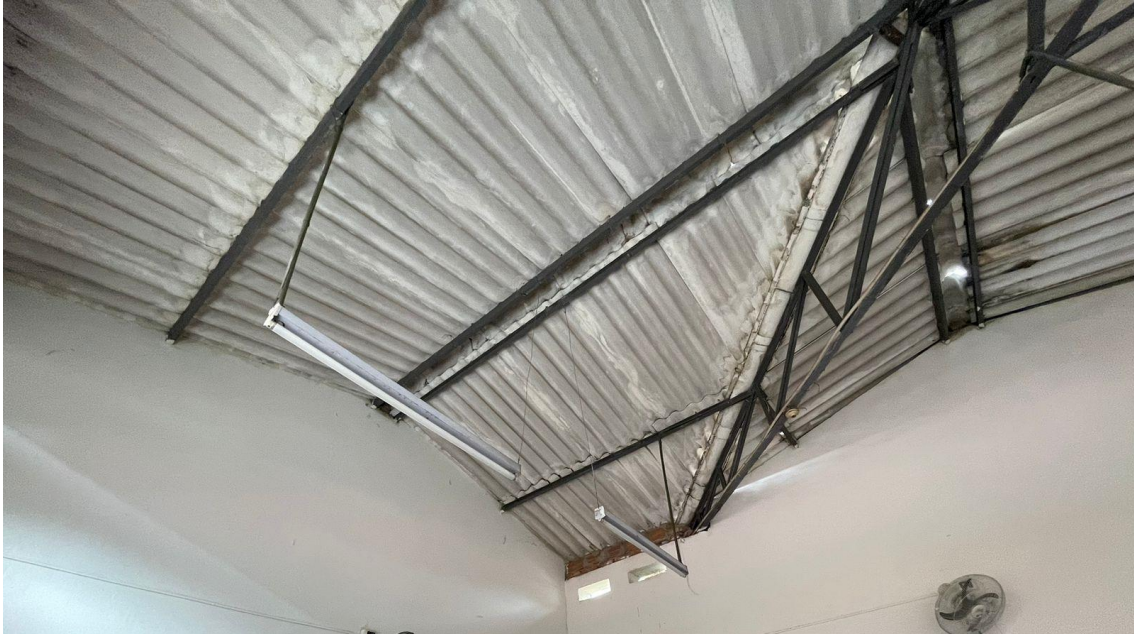
Fotografía No 4: Teja y Lamparas para desmontar debido al mal estado en el que se encuentran
