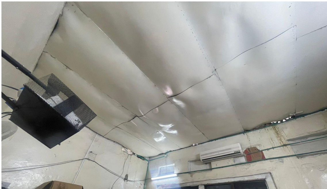
Fotografía No 5: Cieloraso en lamina de la sala de informatica en mal estado
