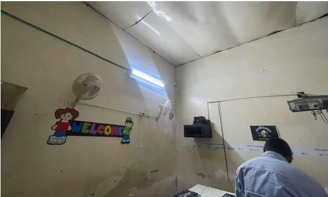
Fotografía No 7: Muros de la sala de informatica con mal aspecto por falta de pintura
