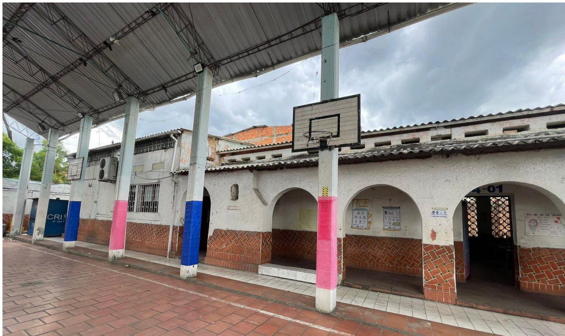
Fotografía No 10: Muros exteriores con mal aspecto por falta de pintura
