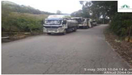
Zona de pavimento para rehabilitar
