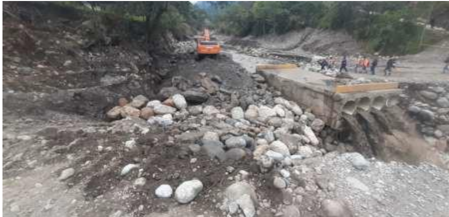
Ilustración 3 - Pérdida de aproches por avenida torrencial
