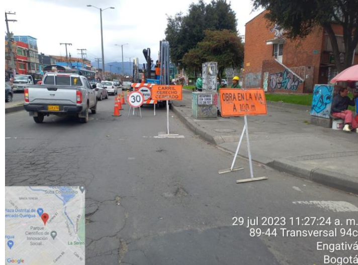
Imagen 1. PMT EN CALZADA EXT 1872
