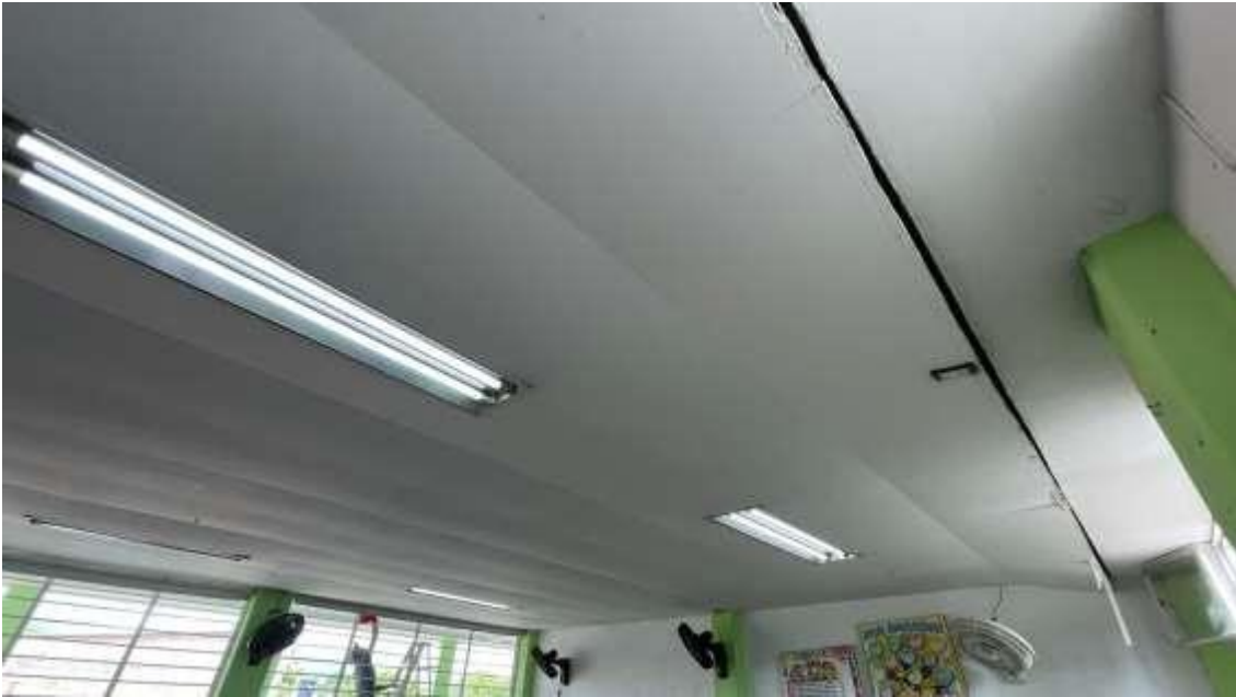
Fotografía No 2: Cielorraso en mal estado lo cual genera riesgo dentro del aula
