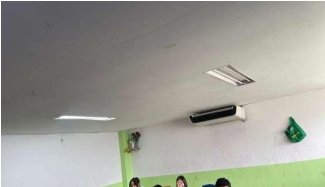
Fotografia No 5: Luminarias en mal estado
