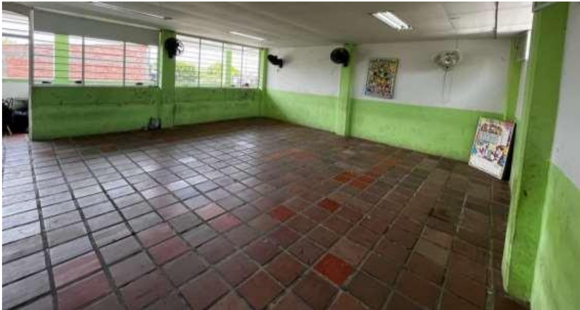
Fotografía No 9: Piso en tablon de gres para cambio por piso en ceramica
