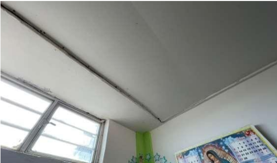
Fotografía No 3: Cielorraso en mal estado lo cual genera riesgo dentro del aula
