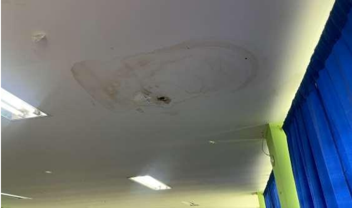
Fotografia No 4: Cielorraso en mal estado lo cual genera humedad dentro del aula
