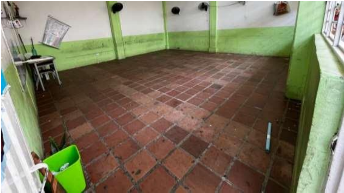
Fotografía No 8: Piso en tablon de gres para cambio por piso en ceramica
