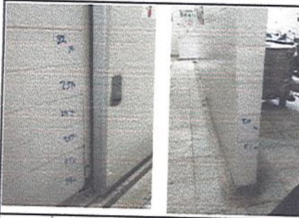
FOTO 1 COLEGIO ANTONIA SANTOS revisión piezas de enchape a cambiar
