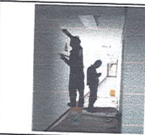
FOTO 10 COLEGIO ANTONIO RICAURTE Correcciones pintura pasillo segundo piso
