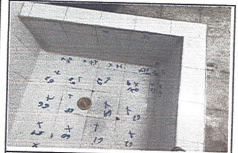
FOTO 3 COLEGIO ANTONIA SANTOS Ollero revisión piezas de enchape a cambiar
