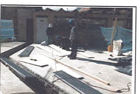
FOTO 9 COLEGIO ALFREDO IRIARTE Rejillas Caracamo
