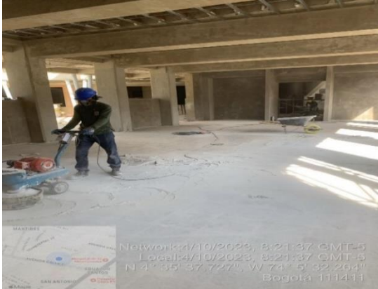
Destronque de enchapes de pisos en granito pulido - sector 2 // salón múltiple // nivel 1.
