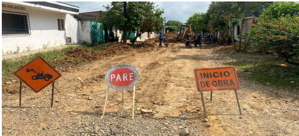
Imagen 10 Señalización en obra
