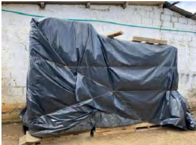
Imagen 8 Cubrimiento de materiales cementantes en bodega
