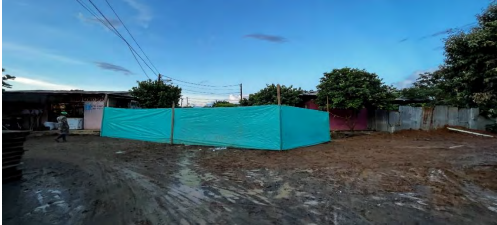
Imagen 11 Señalización en obra
