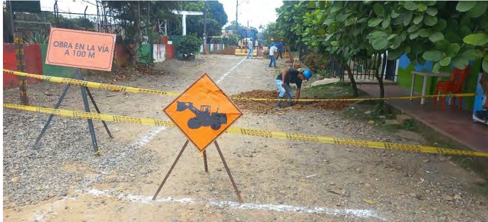
Imagen 9 Señalización en obra
