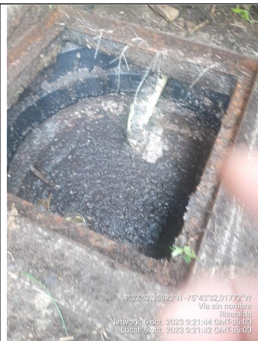
SISTEMA SEPTICO DE LA FINCA GARCIA
