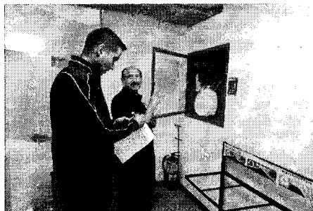
Verificación de gabinetes contra incendios.
