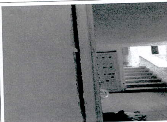
SEPARACION DE MARCO DE PUERTA
