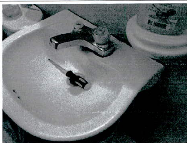
GRIFERIA DE LAVAMANOS EN MAL ESTADO
