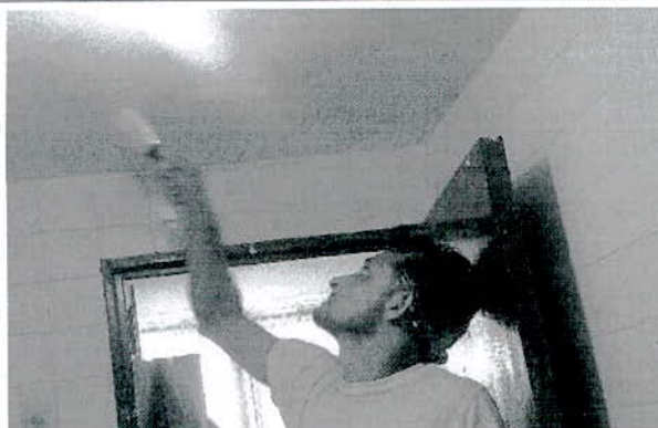
ARREGLO DE HUMEDAD
