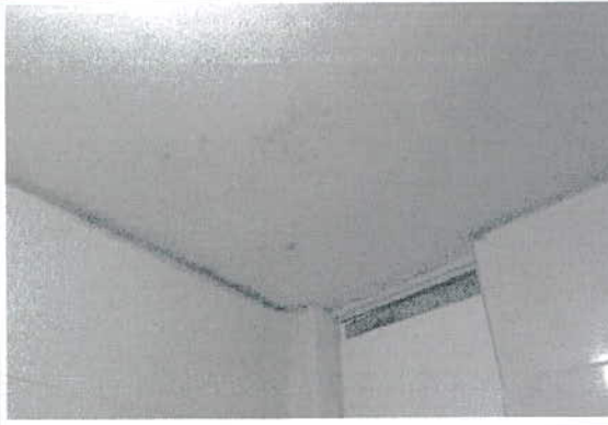
HUMEDAD EN TECHO
