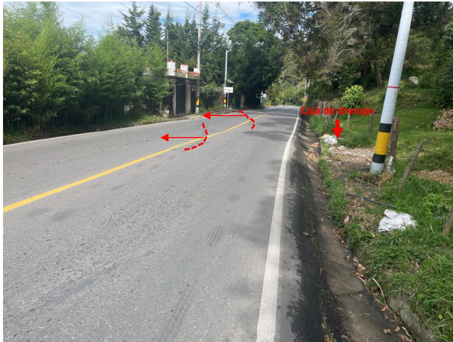
Figura 13. Agrietamientos y hundimiento en la banca vial.
