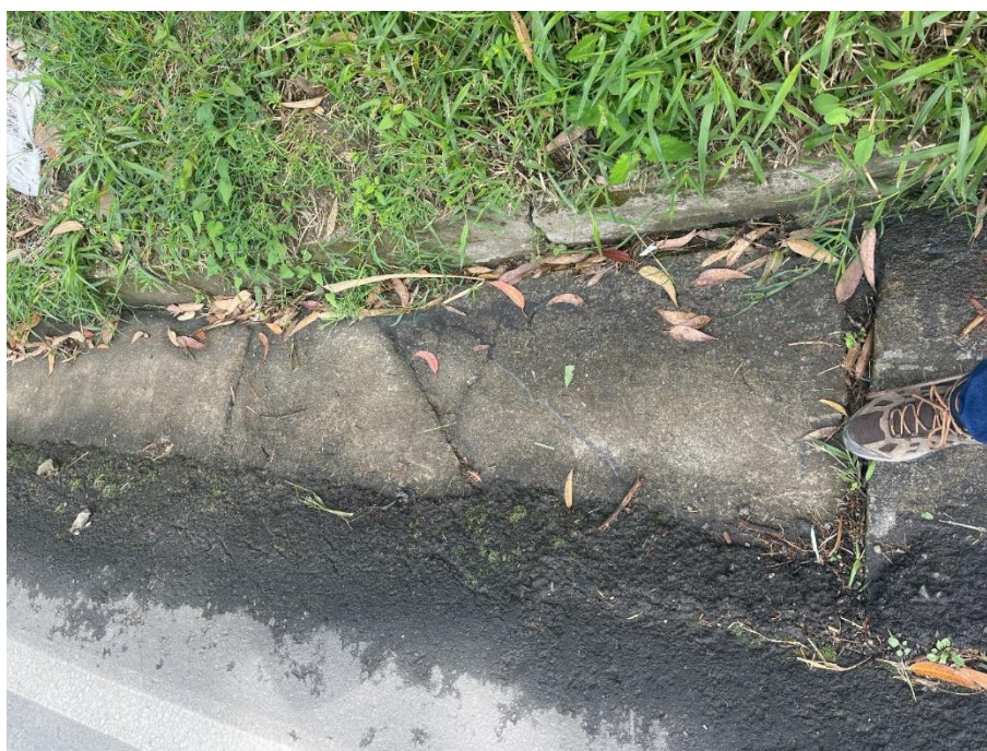
Figura 12. Afectación en la cuneta de la vía.
