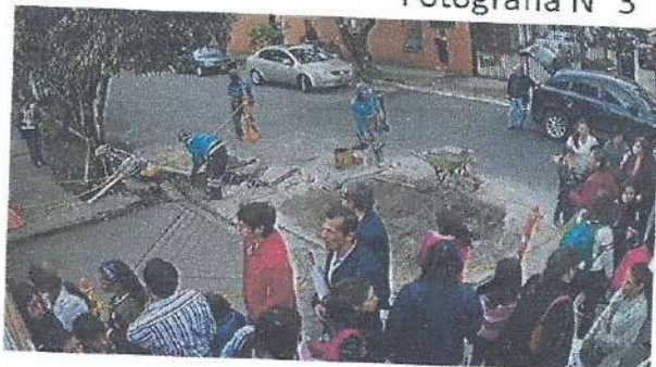
Después del Accidente Corren la Cinta-Peligro y los Escombros
