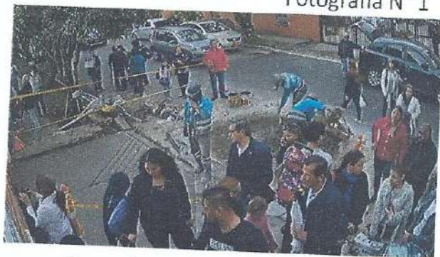
Escombros en la Vía Publica
