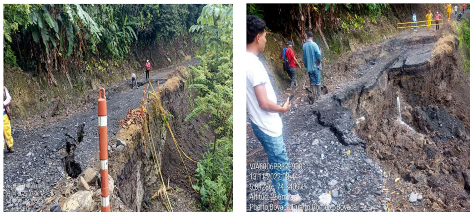
Foto No. 1: PC PR37+900 Ruta 6006 Baja (imagen propia)
