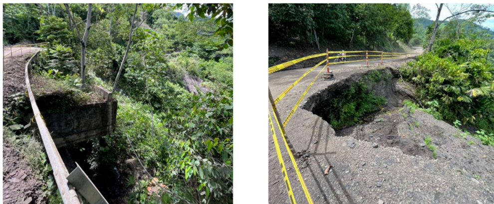
Foto No. 2: PC PR42+500 Ruta 6006 Baja (imagen propia).
