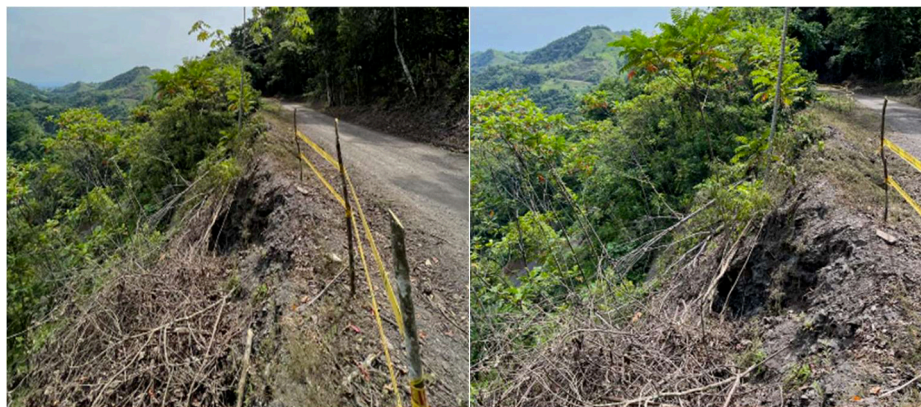
Foto No. 3: PC PR44+100 Ruta 6006 Baja (Imagen propia)
