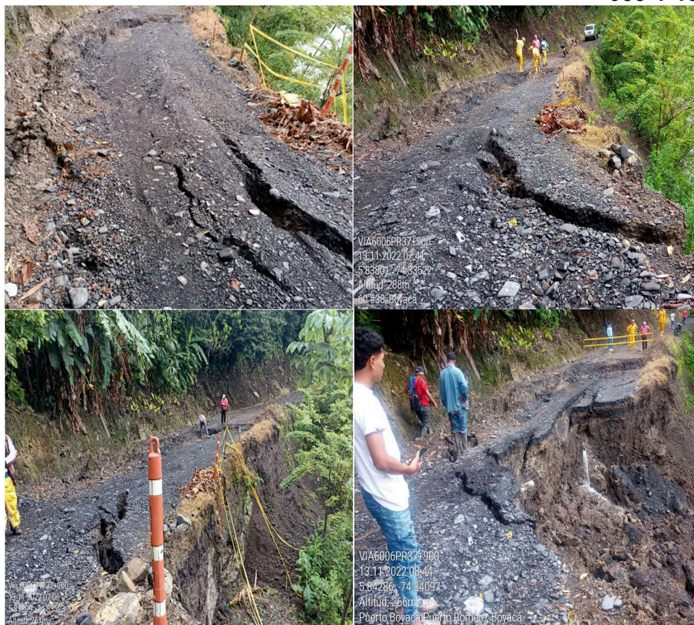
Foto No. 1: PC PR37+900 Ruta 6006 Baja (imagen propia)
