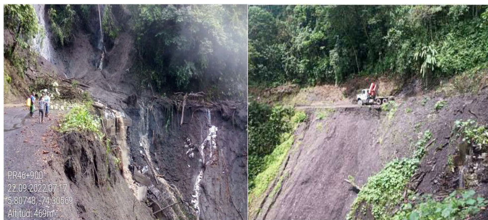
Foto No. 5: PC PR46+600 Ruta 6006 Baja (imagen propia)
