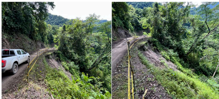
Foto No. 4: PC PR46+200 Ruta 6006 Baja (imagen propia)
