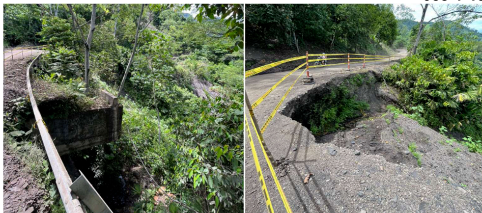
Foto No. 2: PC PR42+500 Ruta 6006 Baja (imagen propia)
