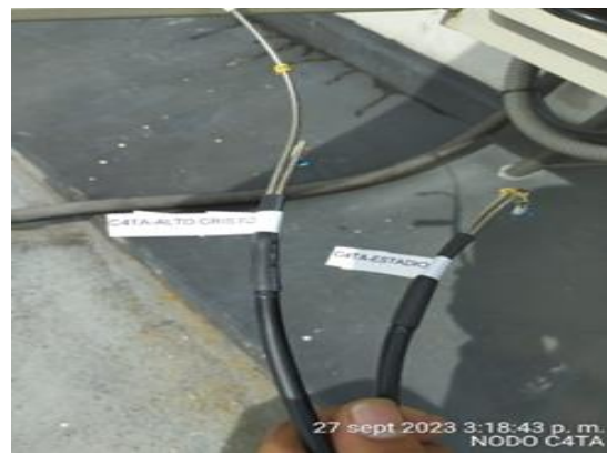
Marquillado y conexiones
