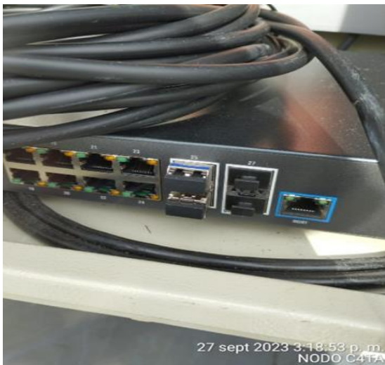
Marquillado y conexiones
