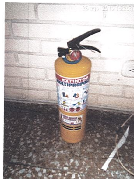
Imagen No16. Equipo de emergencias (extintor ABC)
