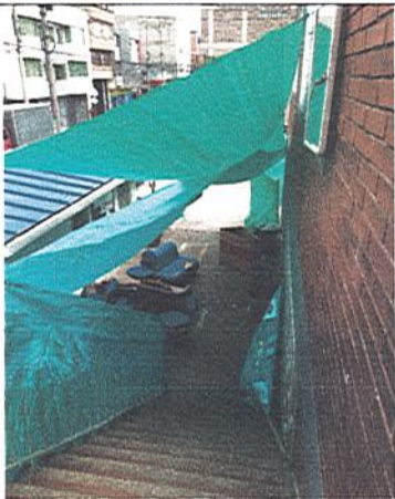
CERRAMIENTO INGRESO A SEGUNDO PISO
