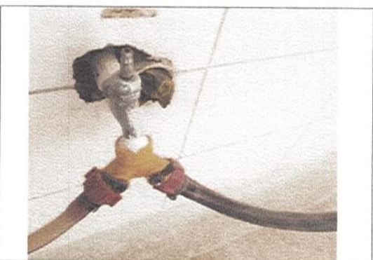
FALTA INSTALACIÓN DE LLAVE JARDIN
