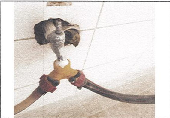
FALTA INSTALACIÓN DE LLAVE JARDIN
