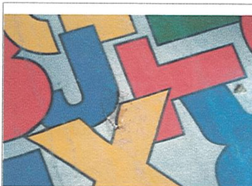
TAPETE DAÑADO DURANTE LA INTERVECION
