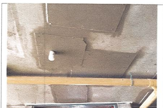
PINTURA PARA TAPAS EN DRYWALL-BIBLIOTECA PENDIENTE ARREGLAR REMATES
