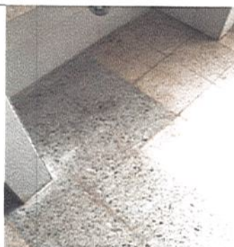
REPOSICION DE BALDOSA
