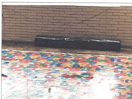
TAPETE DAÑADO DURANTE LA INTERVECION
