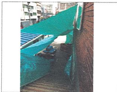
CERRAMIENTO INGRESO A SEGUNDO PISO
