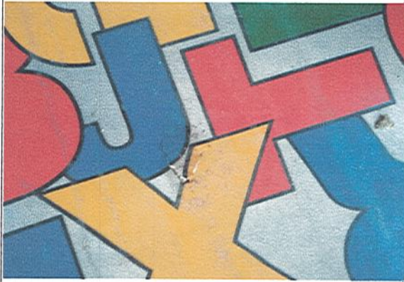
TAPETE DAÑADO DURANTE LA INTERVECION
