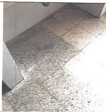
REPOSICION DE BALDOSA
