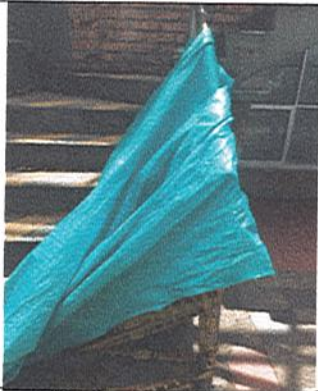
CERRAMIENTOS NO APTOS PARA LA OBRA-SE DEBEN REFORZAR
