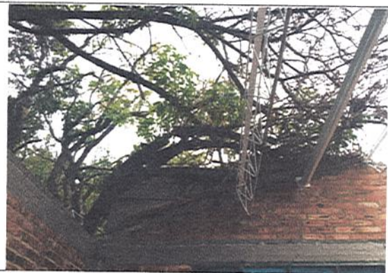
INTERFERENCIA DE ARBORIZACION EN EL MONTAJE DE CUBIERTA
