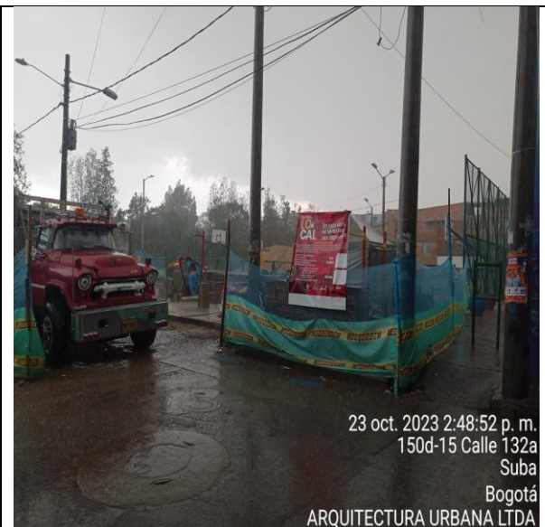
Fotografía N°12. PARQUE LISBOA. COD - II-091. Se presentan fuertes lluvias con granizo en horas de la tarde ocasionando la suspensión de actividades adelantadas producto del apozamiento en el área de las canchas múltiples. Se afectaron las actividades de compactación de fondo de excavación.
