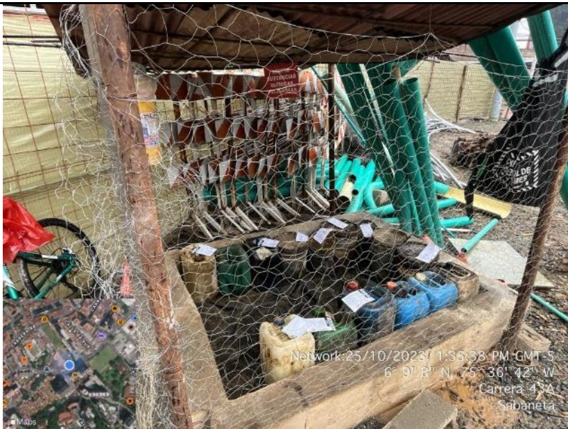
Acopio de Sustancias Químicas
