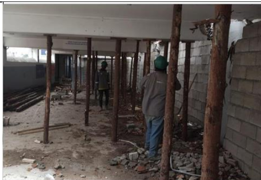
Foto 21: DESCONFINAMIENTO ESTRUCTURAL LOSA
