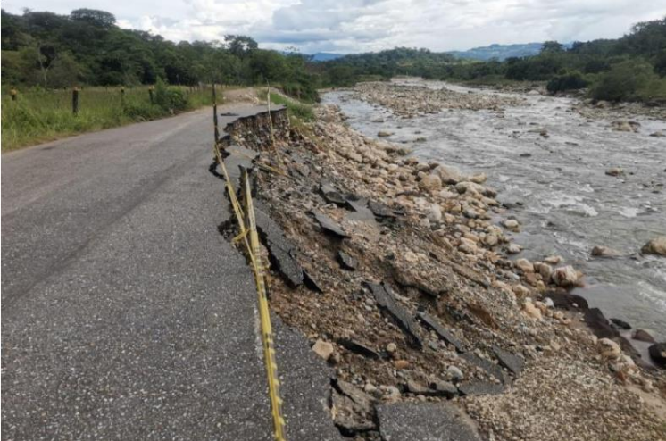
Fotografía 2: Comportamiento del colapso de la banca
