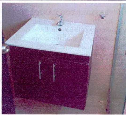
ARREGLO DE LAVAMANOS
