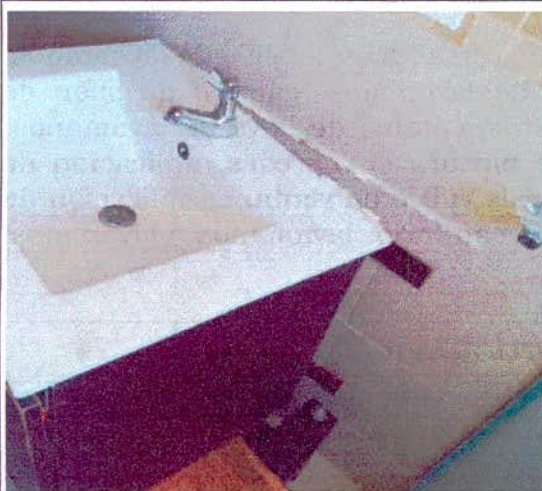
ARREGLO DE LAVAMANOS
