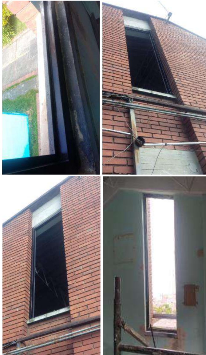
imagen 20. Subsanción filtración por ventana en aula profesores.
