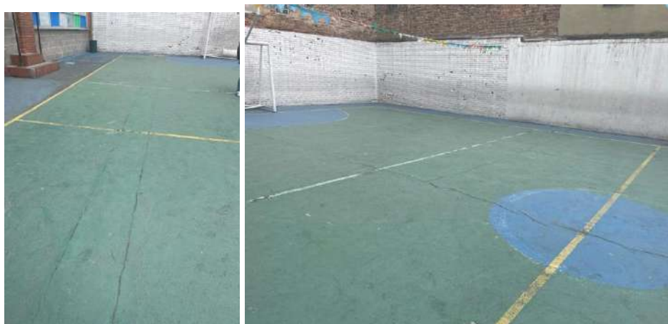
Ilustración 4. Agrietamiento de losa de contrapiso de la cancha
