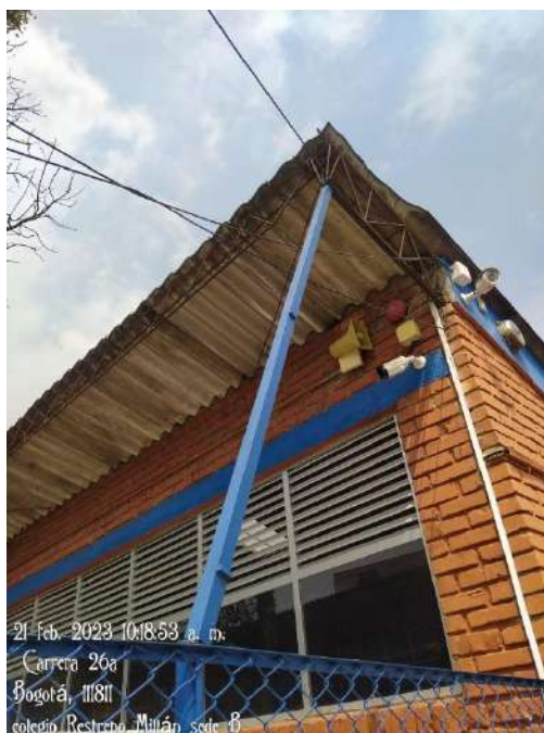
Imagen 16. Poste mal instalado
