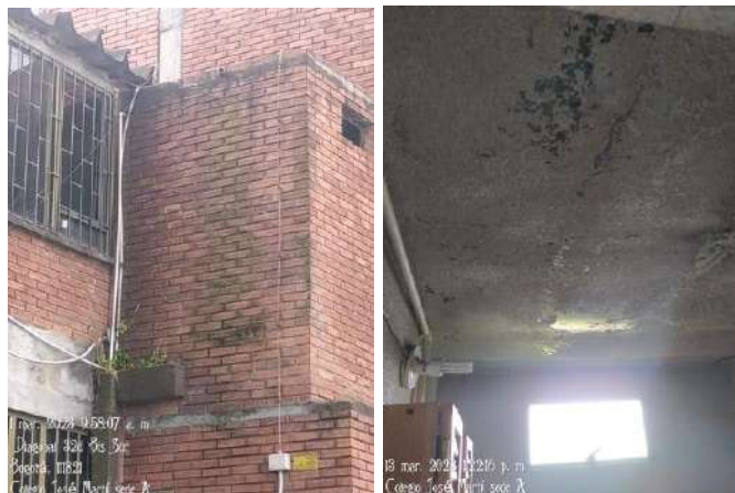
imagen 19. Estado actual de Placa de techo baño orientación.
