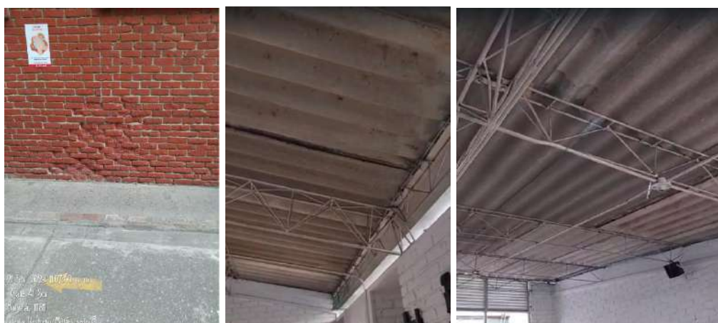
imagen 23. Estado mampostería y estructura metálica
