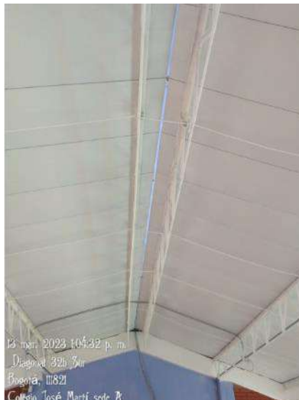
imagen 13. Tubería EMT y cableado en aula profesores
