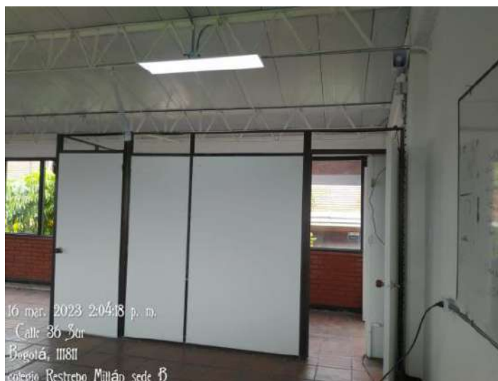
imagen 12. Interruptor y tomacorrientes en aula profesores
