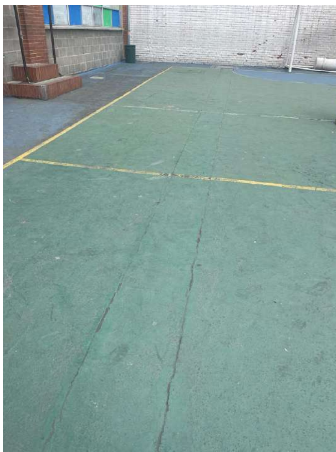
Ilustración 8. Grietas que marcan los canales del alcantarillado
