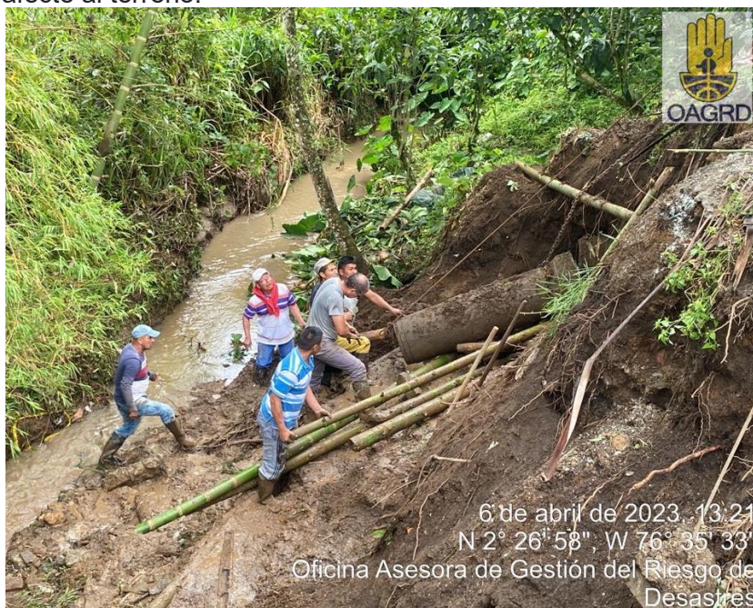
Fotografía No. 4 – Descarga de aguas en la Quebrada.
