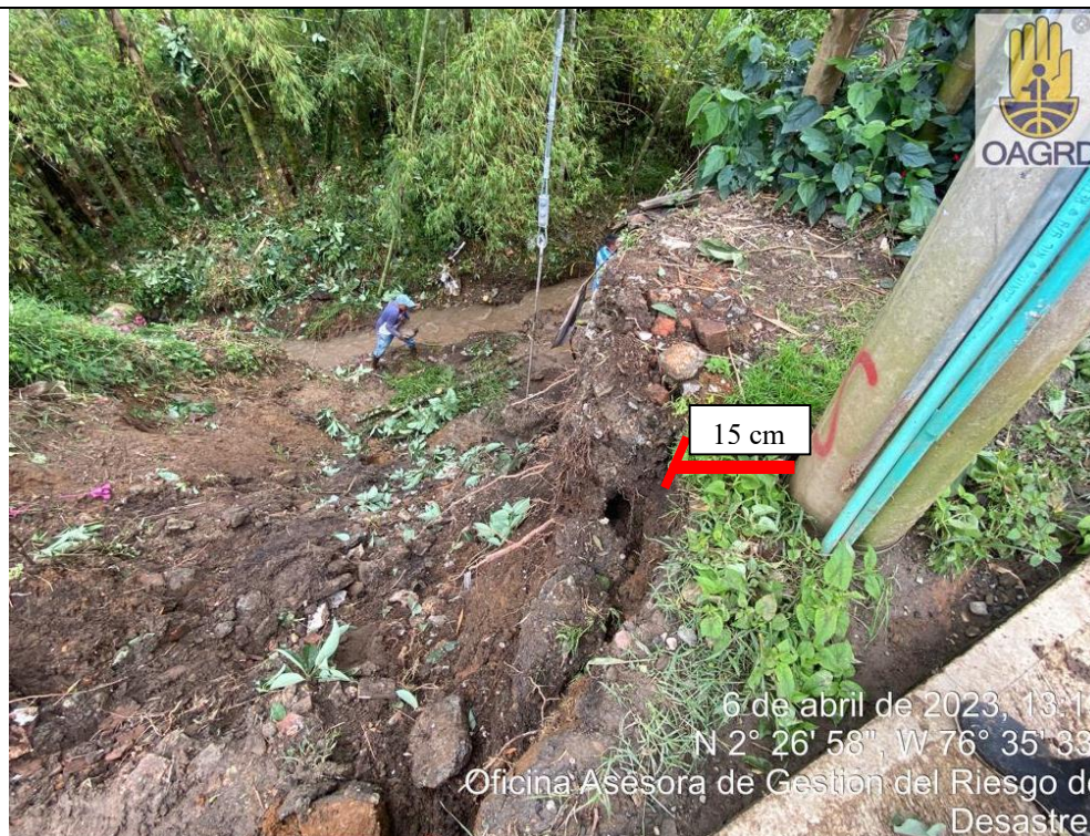
Fotografía No. 2 – Poste eléctrico perteneciente a la CEO.
