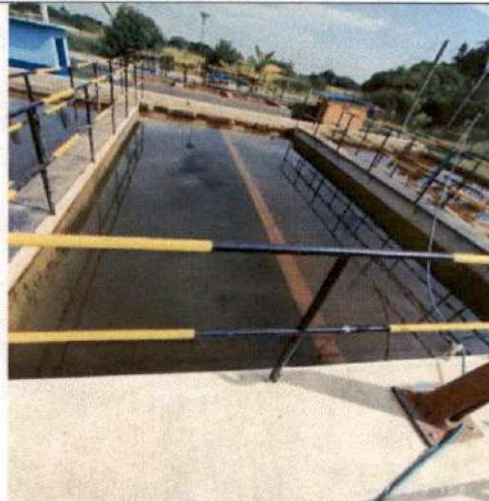
Fotografía 18. Linea 2 de sedimentación a optimizar en PTAP Guacarí
