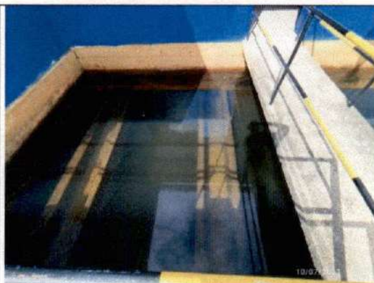
Fotografía 20. Filtros batería 1 a optimizar
