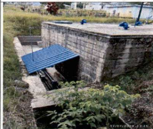
Fotografía 23. Localización de tuberías de salida del tanque Villa Vanegas- La Floresta
