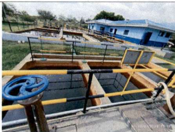
Fotografía 21. Filtros batería 2 a optimizar
