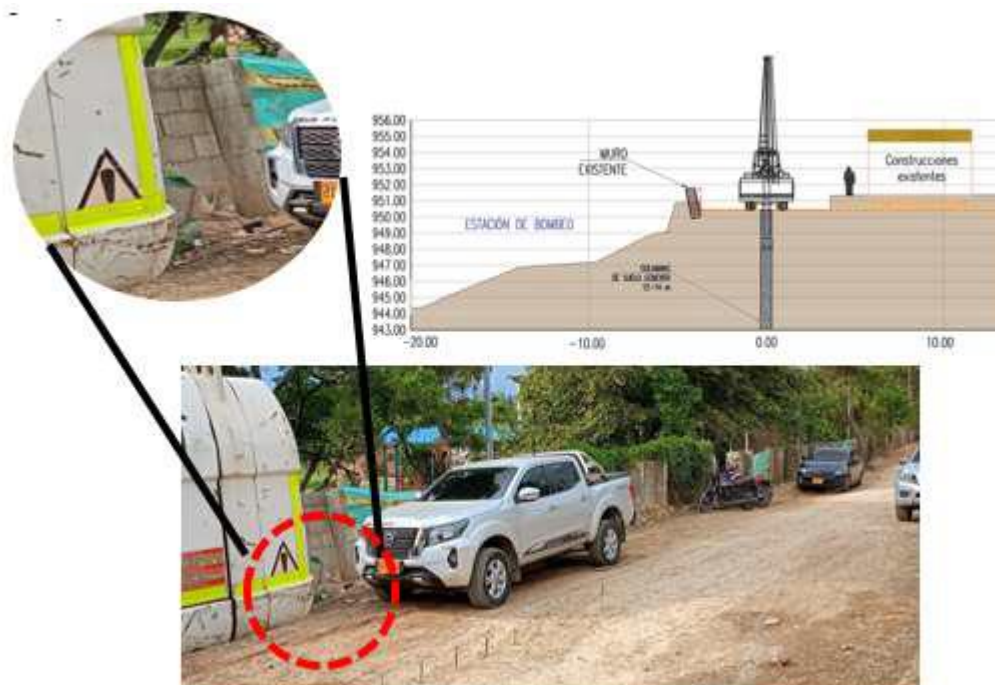
Ilustración 3 Estado actual de muro cerramiento, elaboración propia
