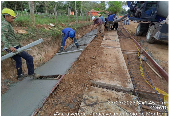
Se evidencia fundida de berma cuneta en tramo N°02
