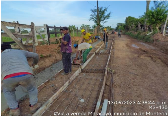
Se evidencia fundida de placa huella sobre la abscisa relacionada
